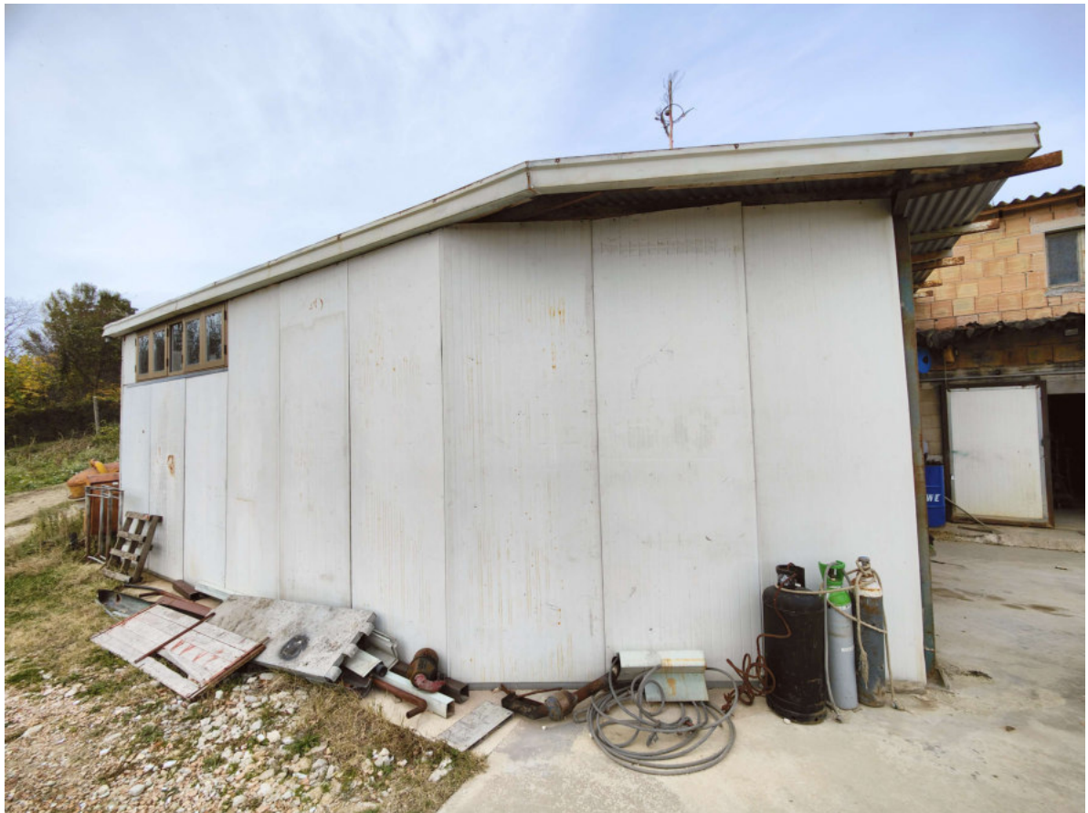
11) Struttura precaria (3) da rimuovere
