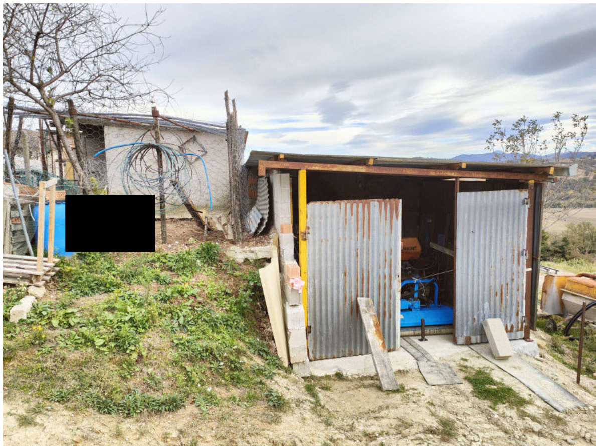
09) Struttura precaria (2) da rimuovere
