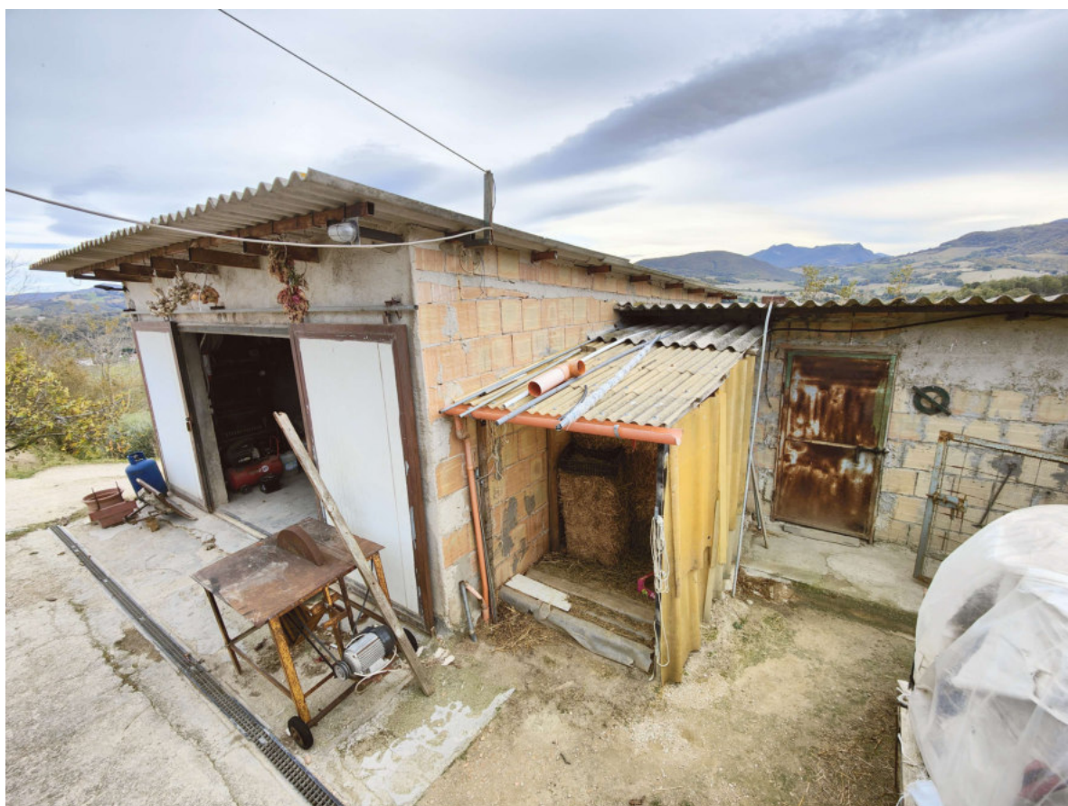
08) Struttura precaria (1) da rimuovere
