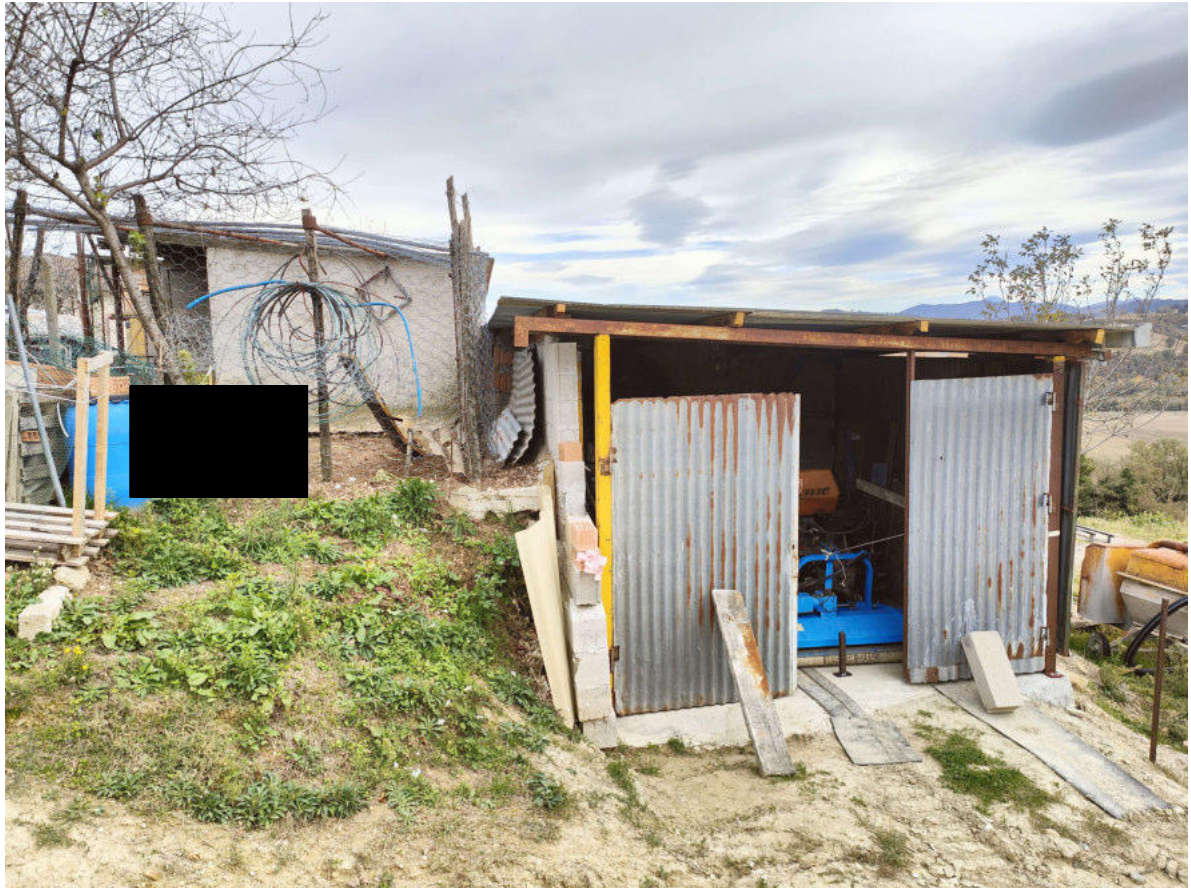
09) Struttura precaria (2) da rimuovere
