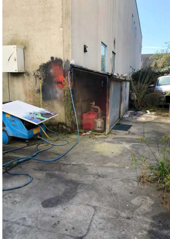
Foto n. 28- Lato Ovest -baracca difforme
