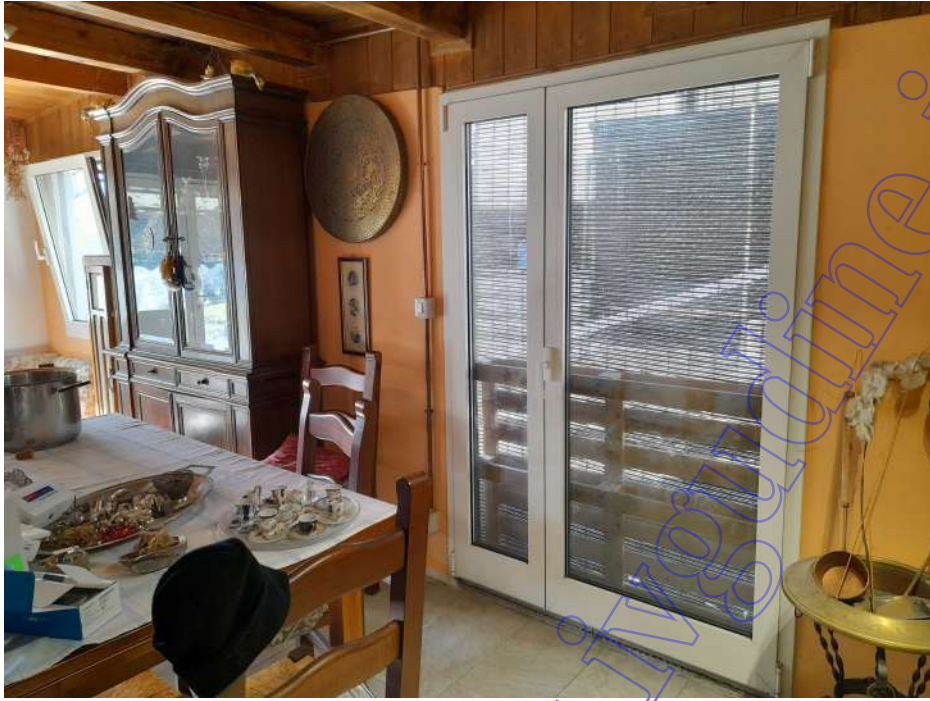
Deposito parzialmente abusivo
