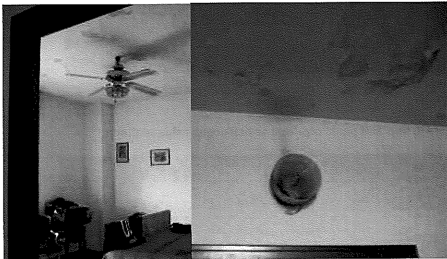
Figura 7: Infiltrazioni al piano secondo.
