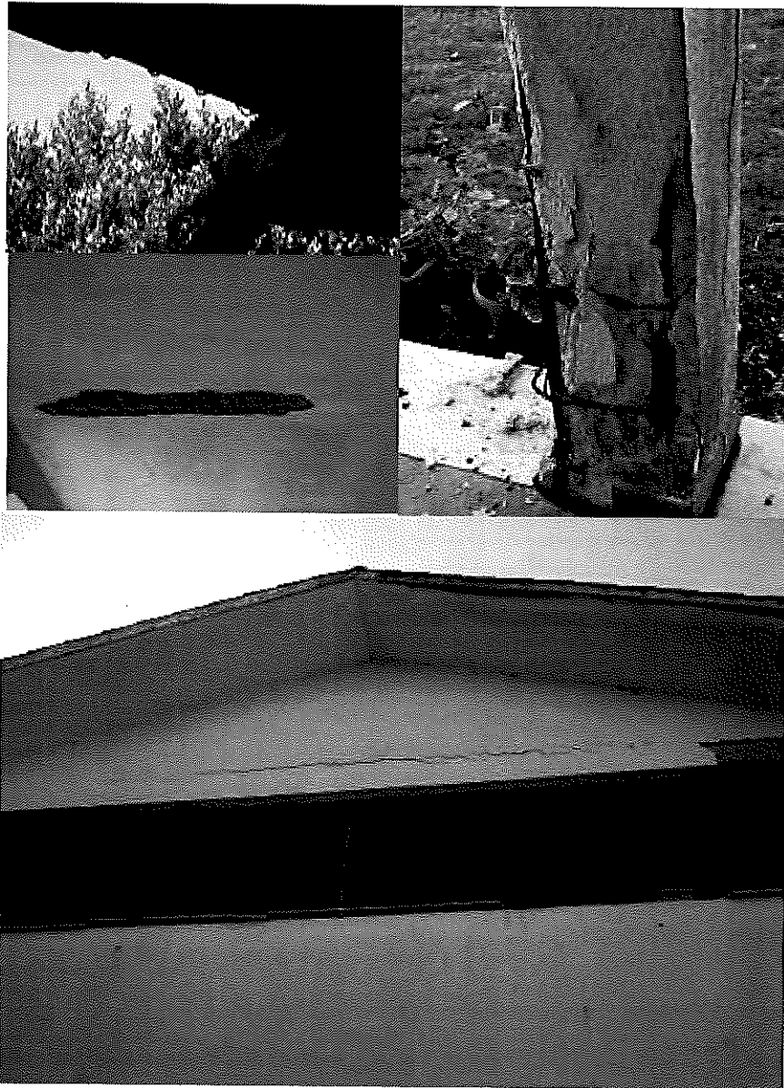
Figura 3: Vista dello stato di degrado della struttura
