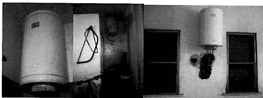
Figura 9: Impianti per la produzione dell'acqua calda sanitaria.
