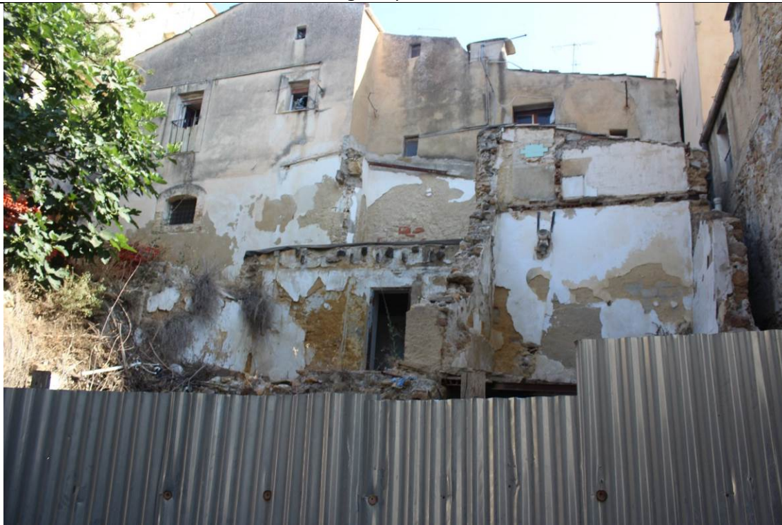
Foto n. 1 - Fabbricati diruti – catastati al fg. 87 part. 4355 sub. 1, 2 e 3
