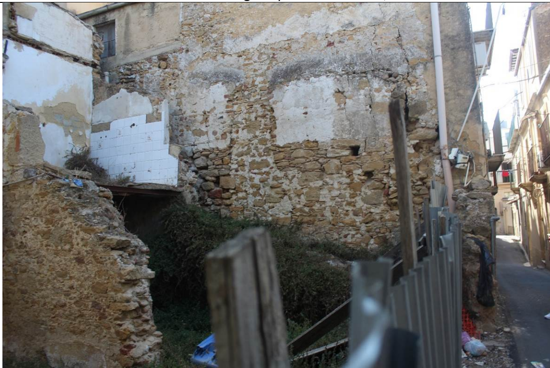
Foto n. 2 - Fabbricati diruti – catastati al fg. 87 part. 4355 sub. 1, 2 e 3
