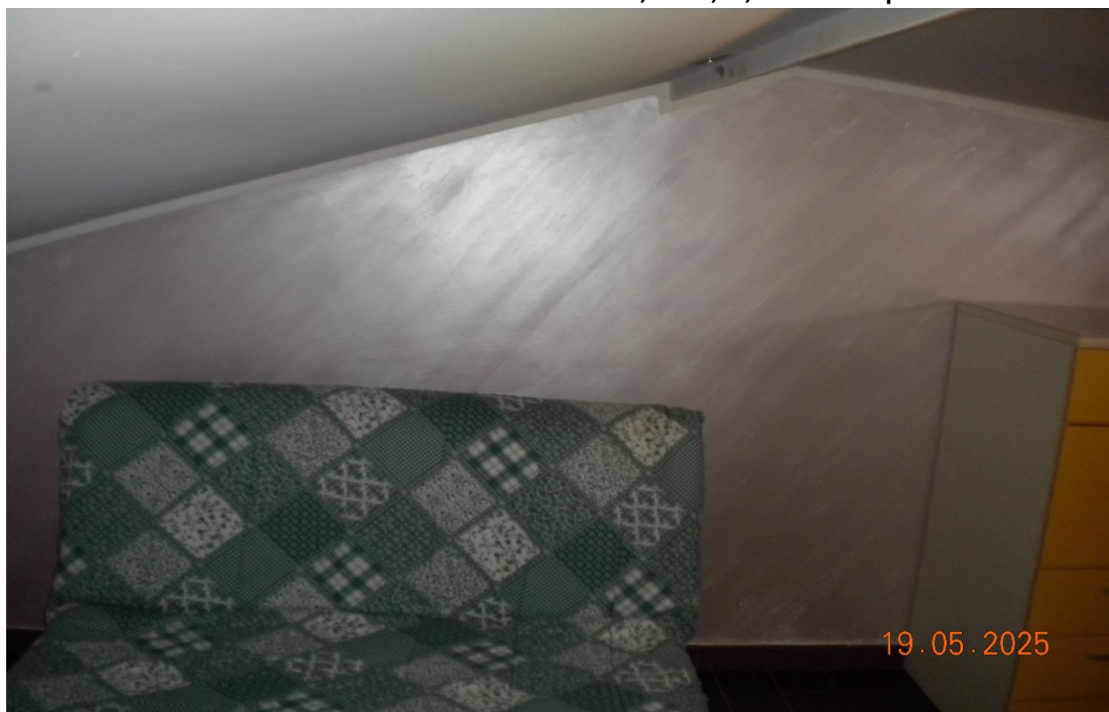
Vista interna accessorio con altezza utile variabile da mt. 1,80 a 1,50; al secondo piano sottotetto.
