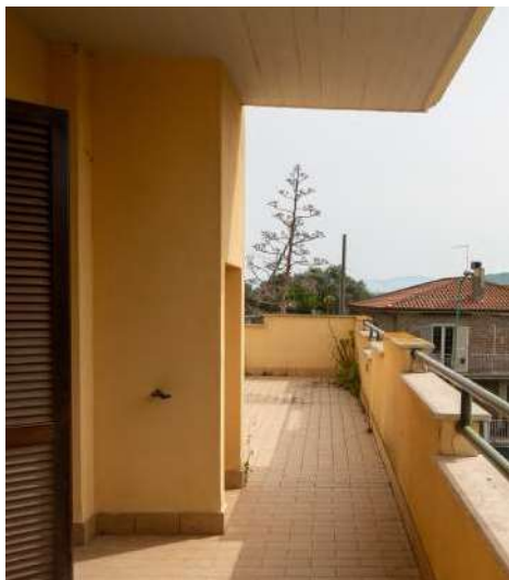
Accessorio Difforme Realizzato in Continuità con la muratura perimetrale
