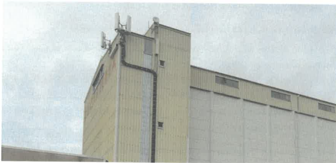
Particolare antenne/ripetitori telecomunicazioni poste sulla copertura del Sementificio
