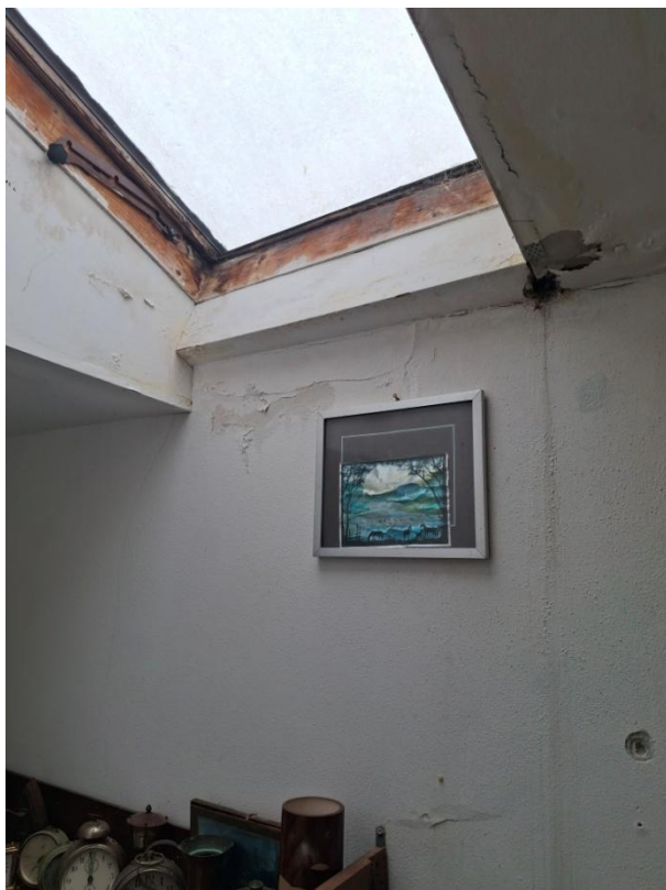
LUCERNARIO SU SCALE CON IDENTIFAZIONE TRACCE D'INFILTRAZIONI ACQUA
