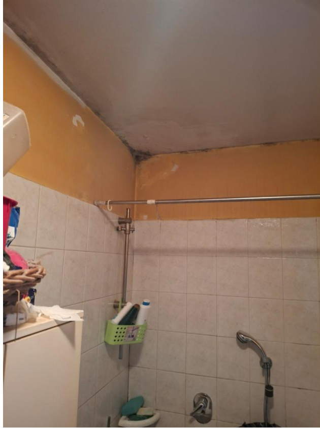
BAGNO - ZONE CON MUFFA LATO OVEST
