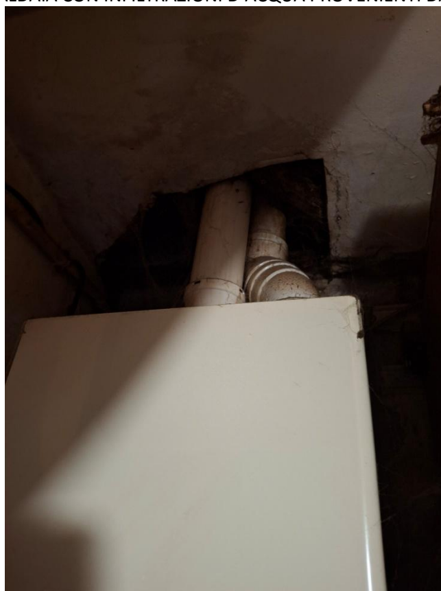
VISTA CALDAIA CON INFILTRAZIONI D'ACQUA PROVENIENTI DAL TETTO
