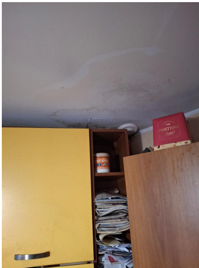
SOGGIORNO CON TRACCE D'INFILTRAZIONI PROVENIENTI DAL TETTO
