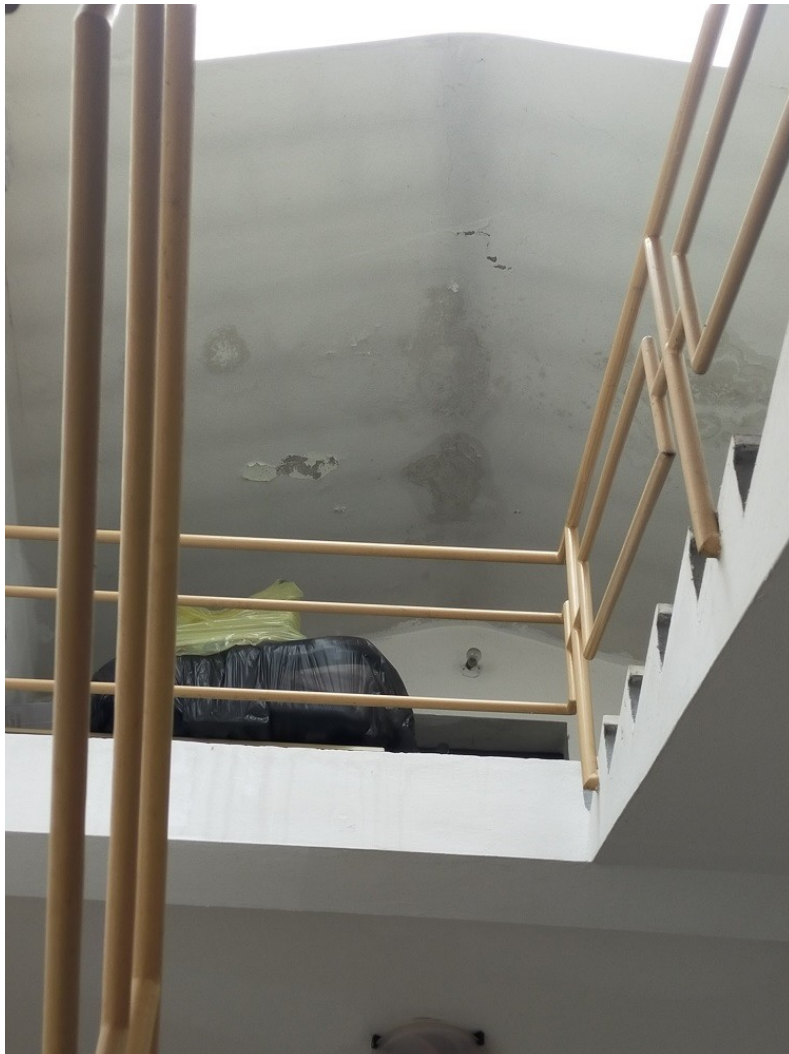
- TRACCE INFILTRAZIONI ZONA SOTTOTETTO -
