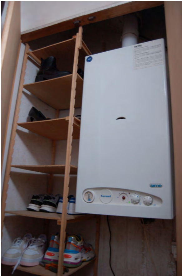
Foto 10 - Armadio a muro per alloggiamento caldaia
