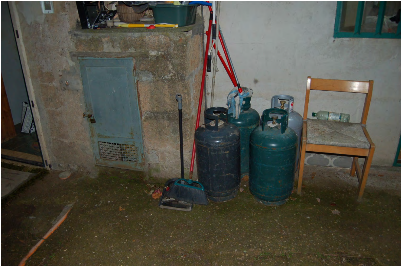
Foto 22 - Gabbiotto per alloggiamento bombole gas
