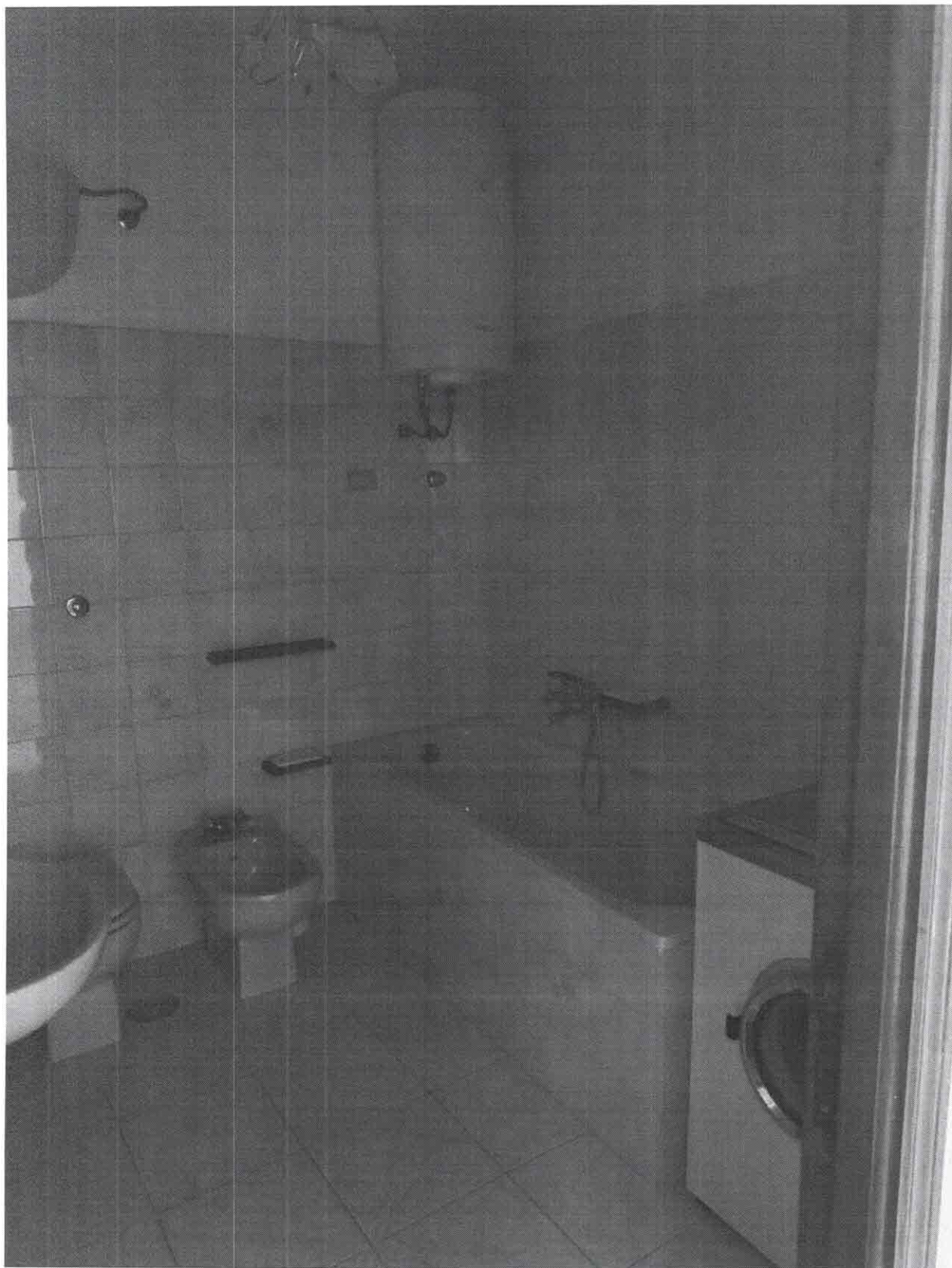
Foto 11: Sanitari, vasca, scaldabagno e lavatrice
