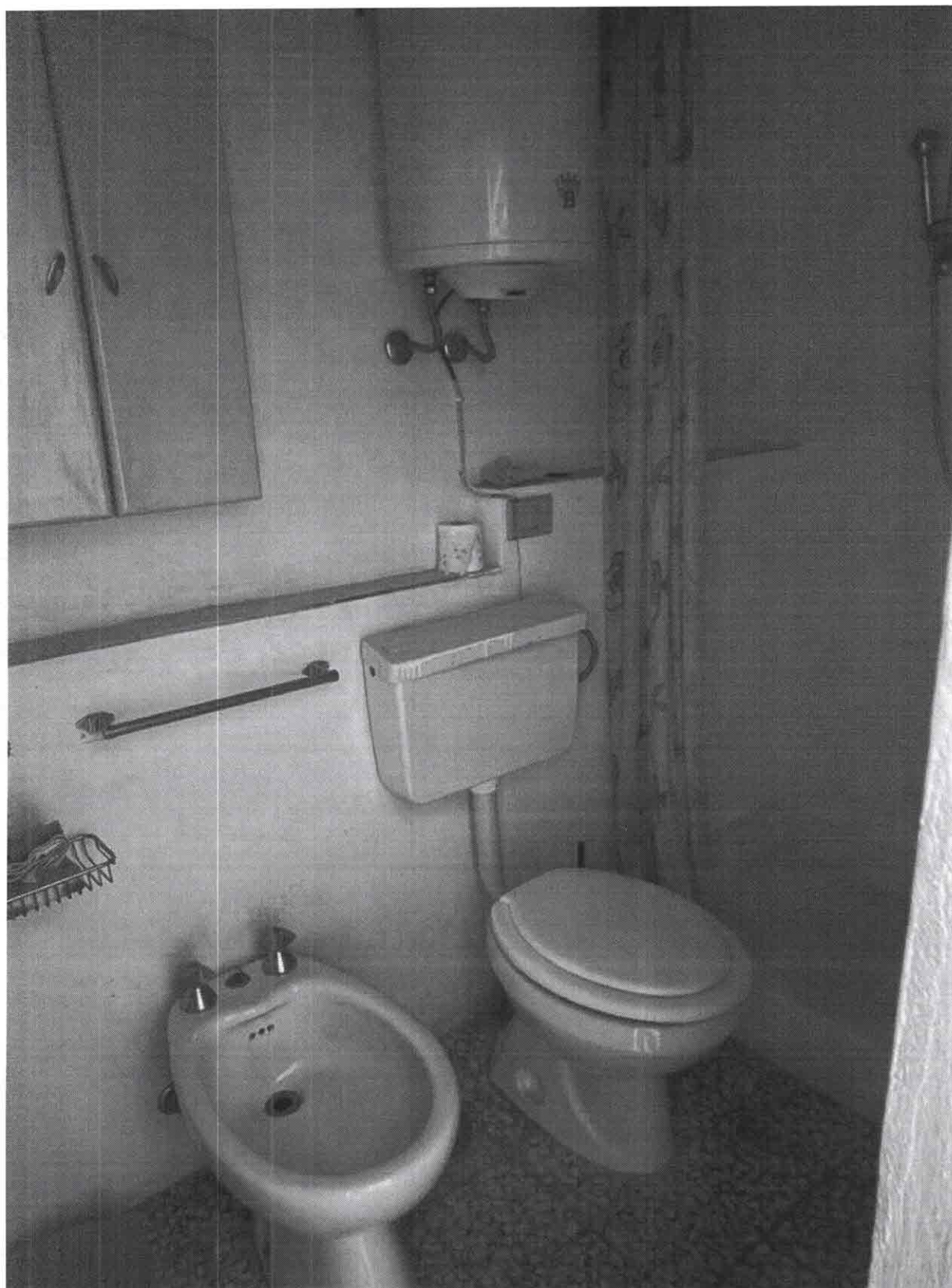
Foto 23: Sanitari del bagno nel sottotetto
