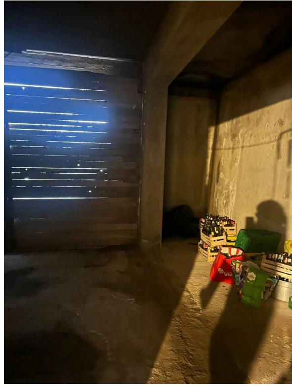
Figura 6 - Parete intercapedine mancante
