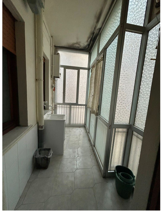
Figura 10 - Balcone chiuso con struttura precaria
