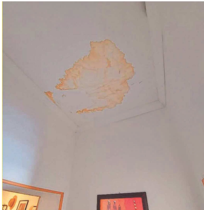
Disimpegno - Tracce fenomeni infiltrativi
