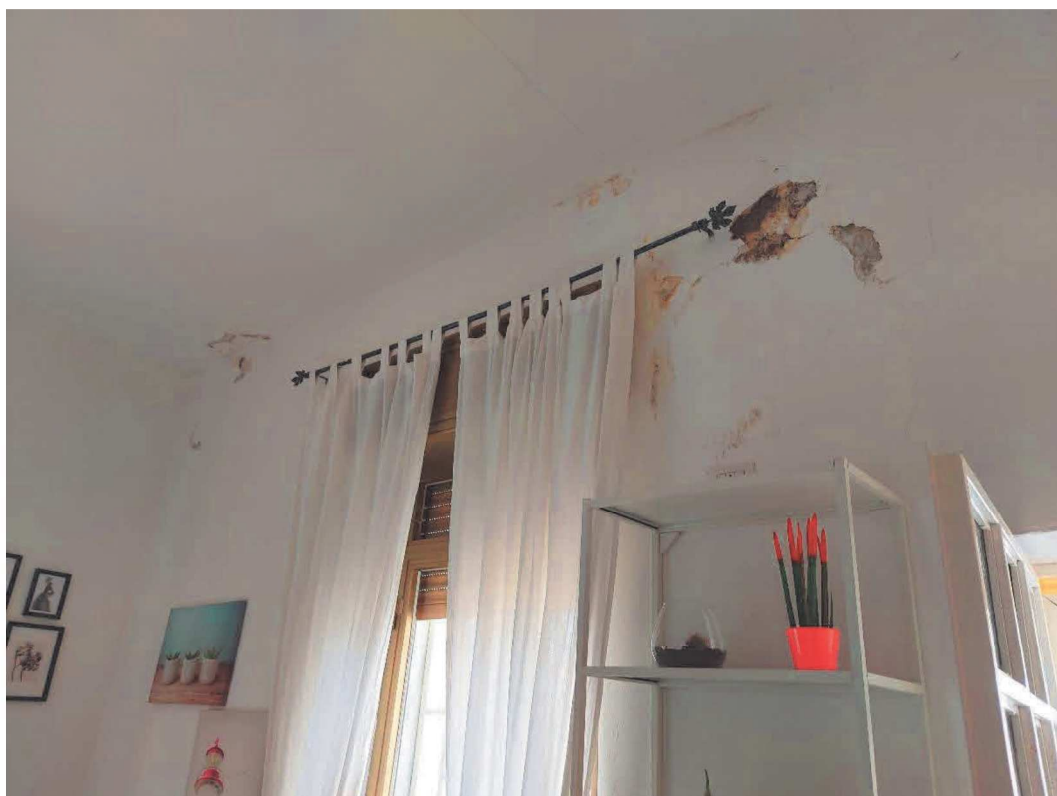
Cucina - Tracce fenomeni infiltrativi
