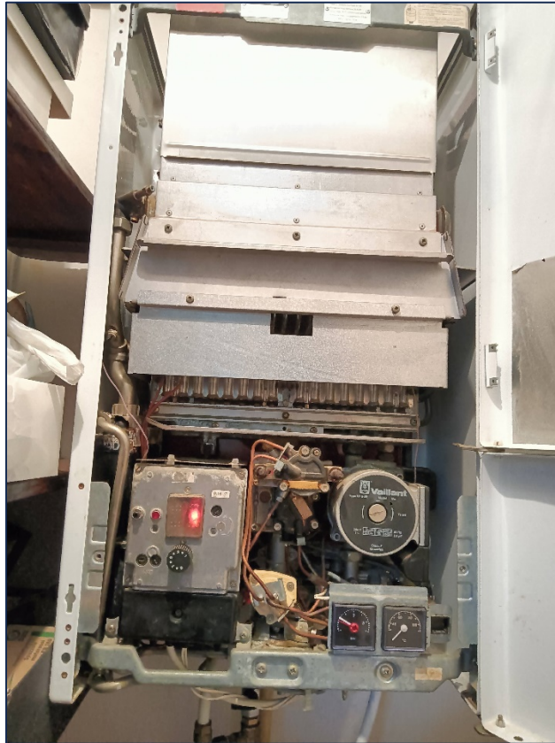
5.1. – Verifica non funzionamento caldaia a gas
