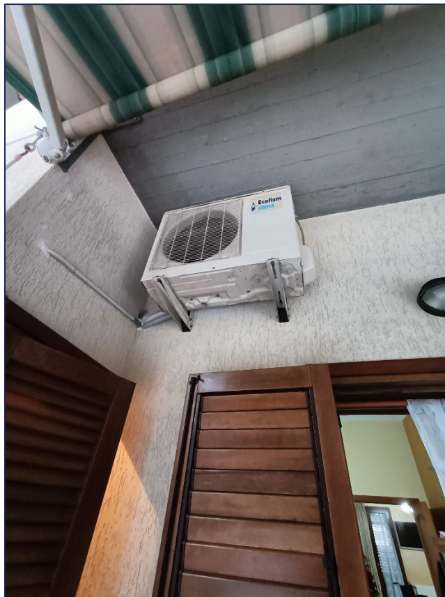
5.4 – Condizionatore non funzionante
