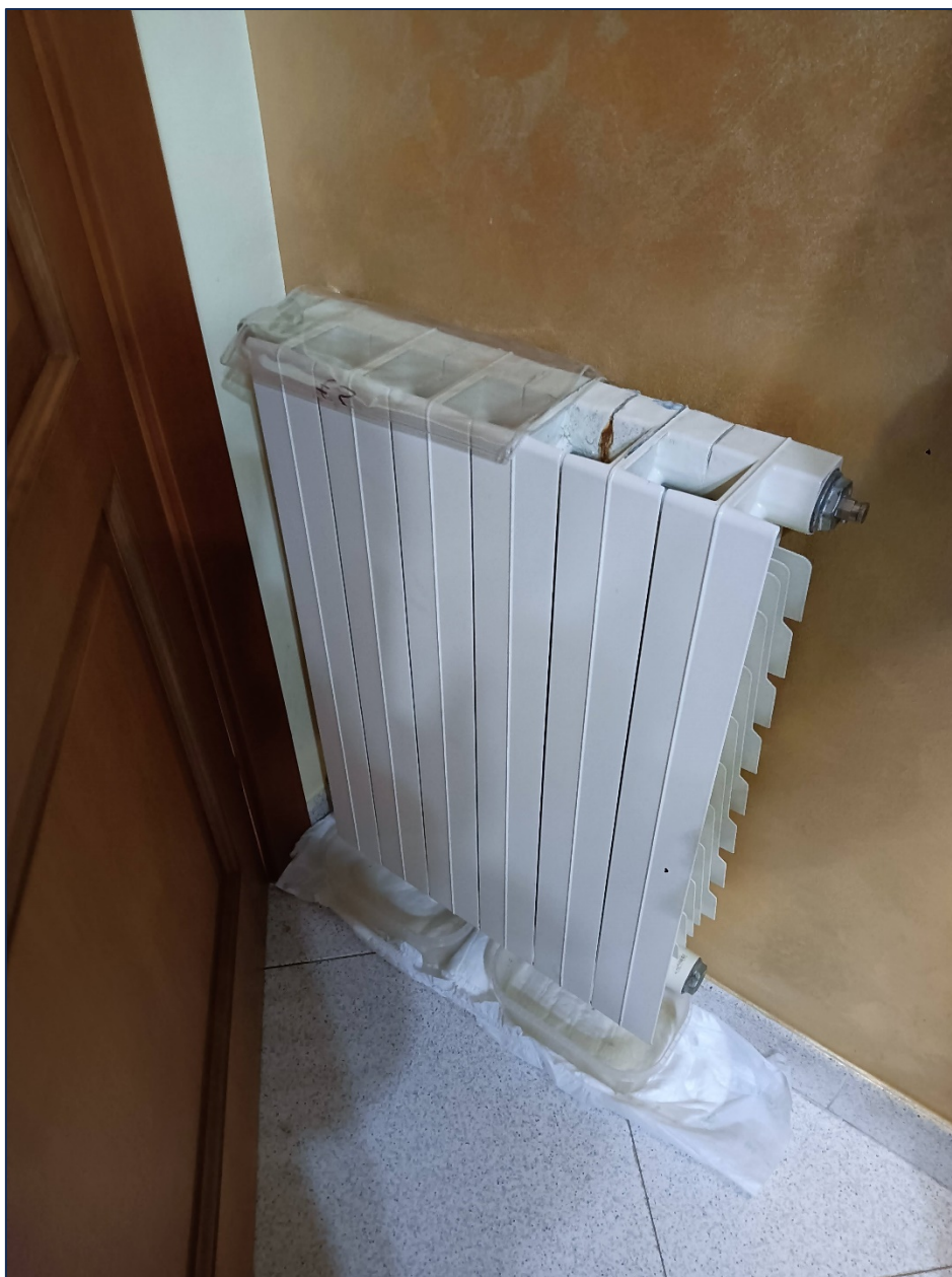
5.5 – Corpo radiante con perdite e ossidazione
