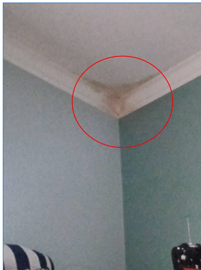
4.8 – Tracce di condensa
