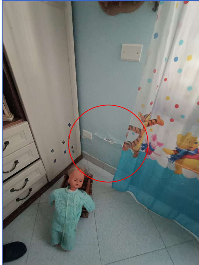
4.9 – Tracce di umidità di risalita
