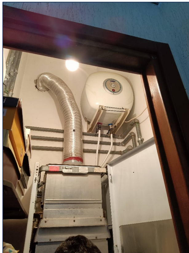
5.2. – presenza di scaldacqua elettrico
