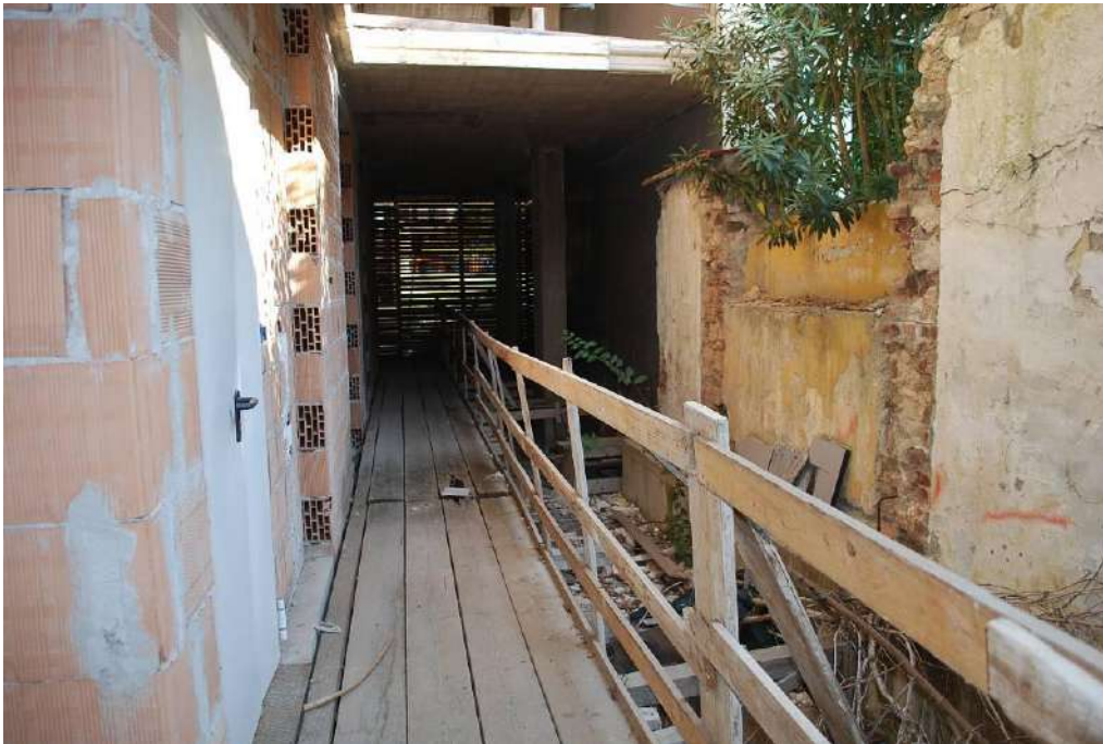
21. Passerella provvisoria pericolante
