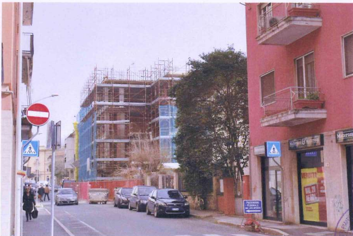
1. Porzione di fabbricato in corso di realizzazione. Veduta del fabbricato da Via Bonghi.
