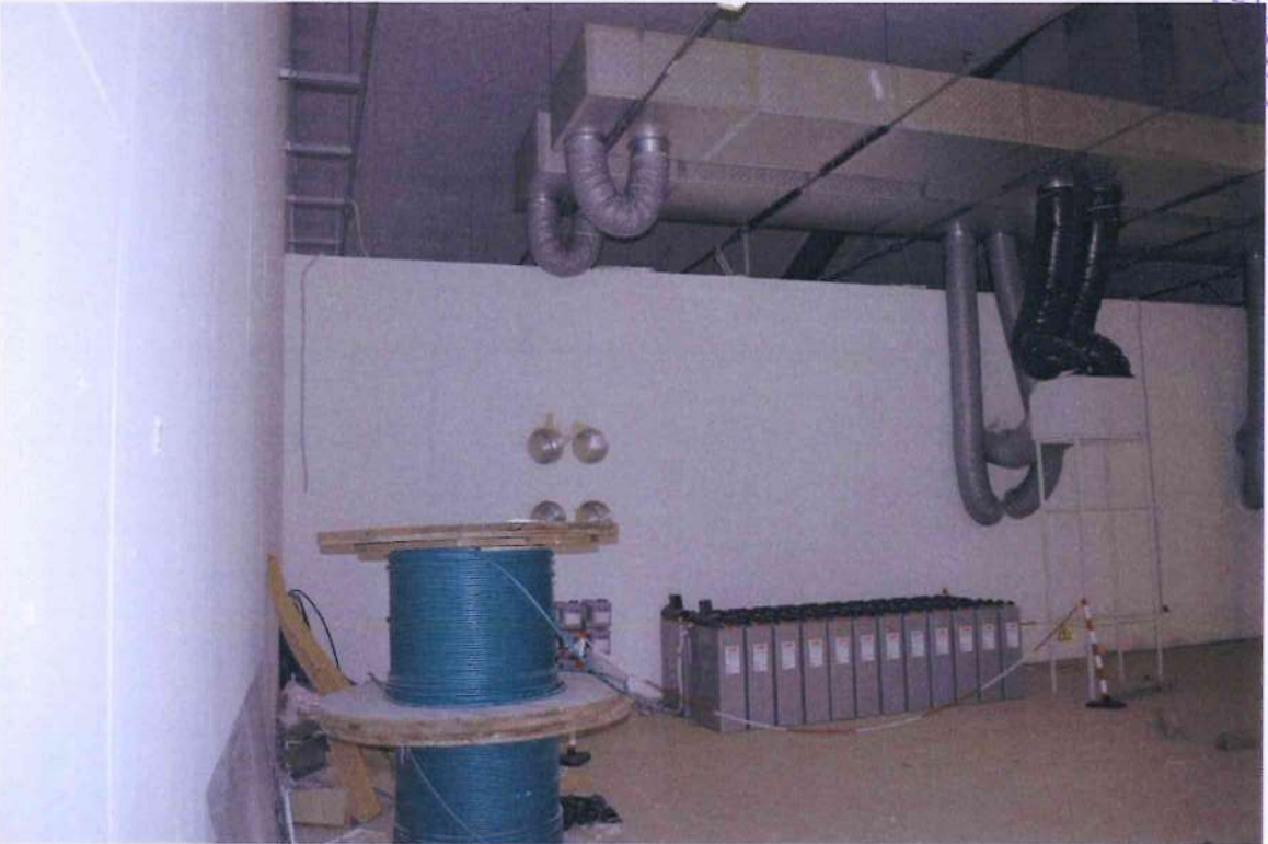
24. Altra veduta dell'interno della centrale telematica.
