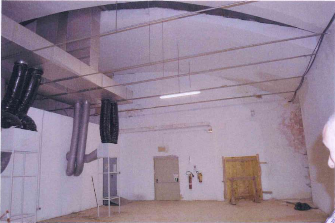
23. Altra veduta dell'interno della centrale telematica.
