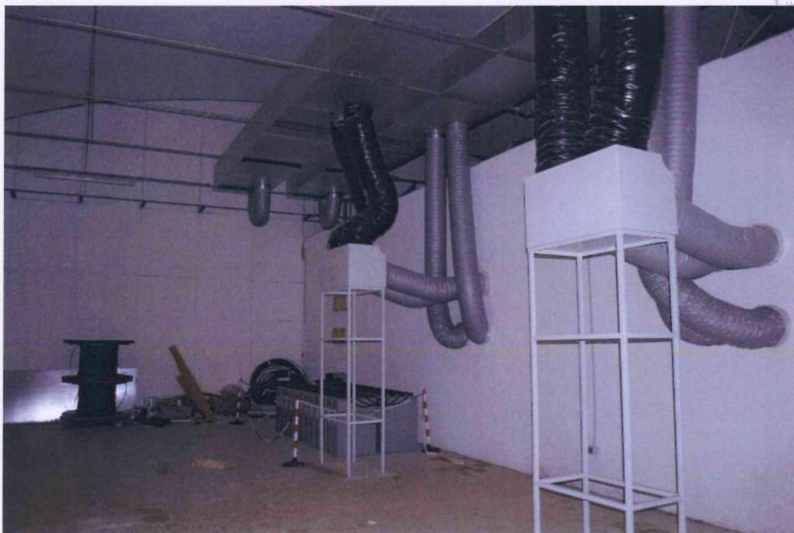
22. Veduta dell'interno della centrale telematica.
