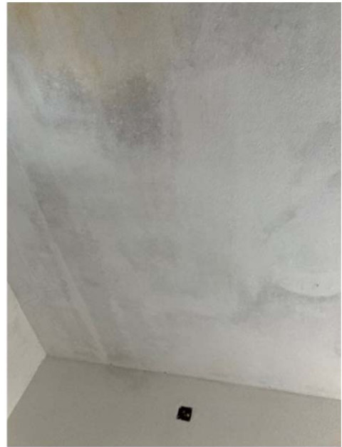
Foto 17. Patologie: il soffitto della camera.
