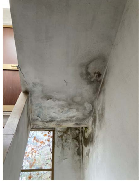
Foto 15. Patologie: infiltrazioni nel vano scala.
