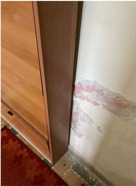
Foto 16. Patologie: il disimpegno ala a sud.
