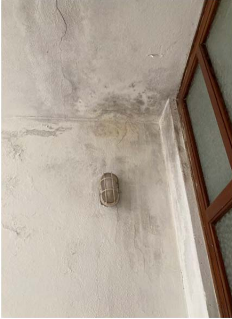
Foto 14. Patologie: infiltrazioni nel vano scala.
