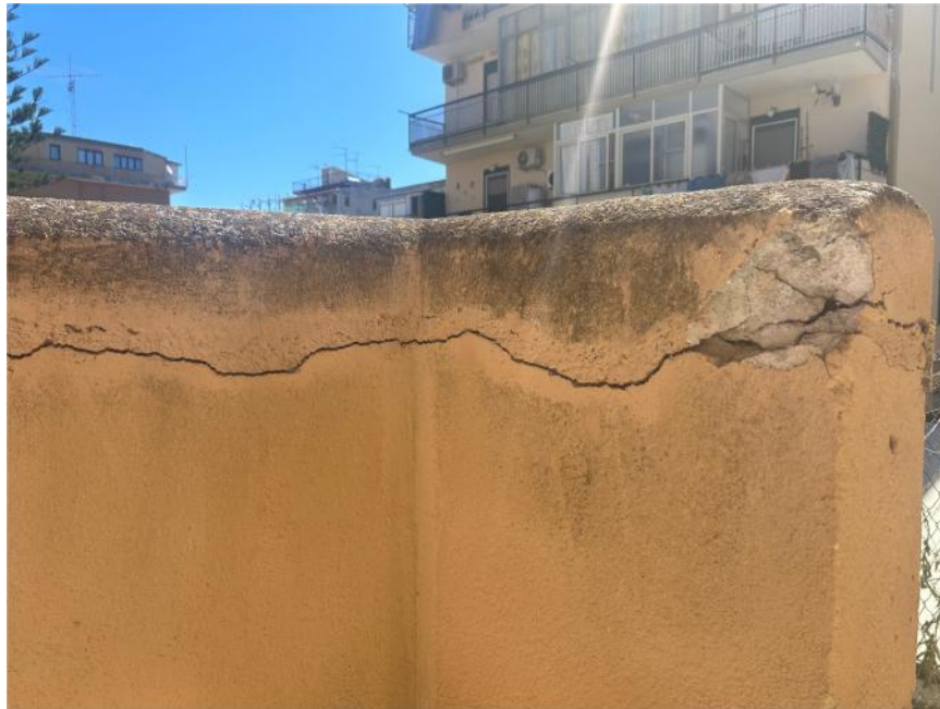
Foto n. 17 - Lesione sul muro del terrazzo
