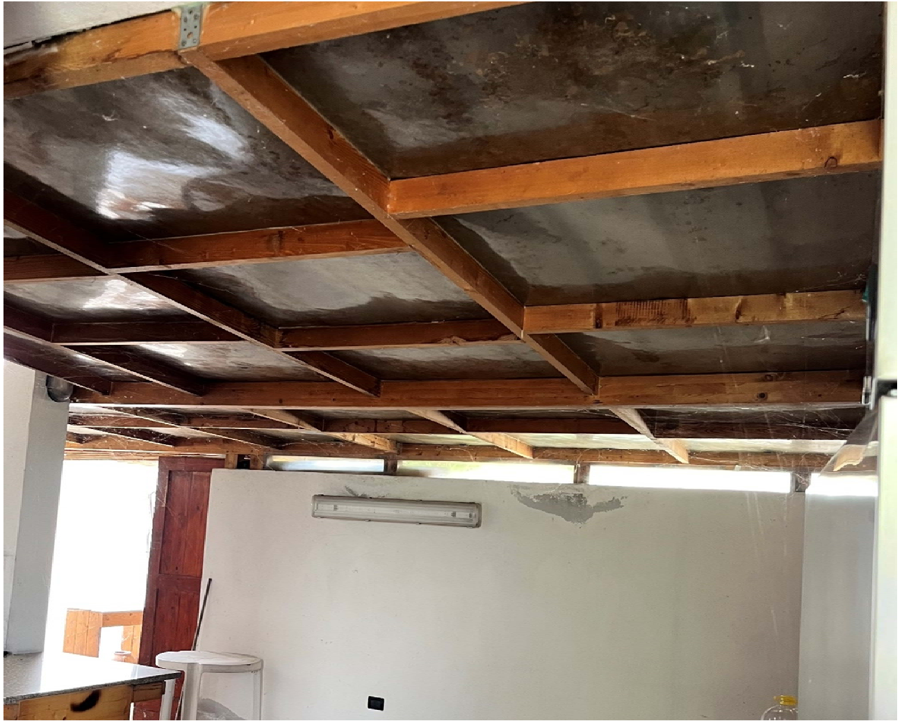
Copertura con pannelli pergole area barbecue
