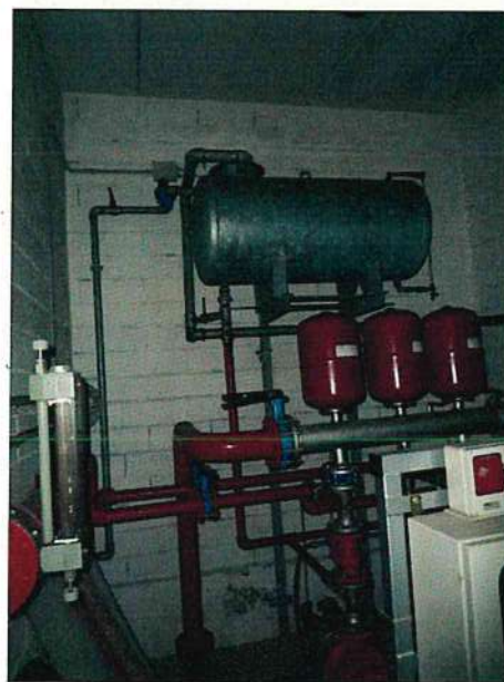
FOTO 47 – INTERNO LOCALE AUTOCLAVE CORPO 14
