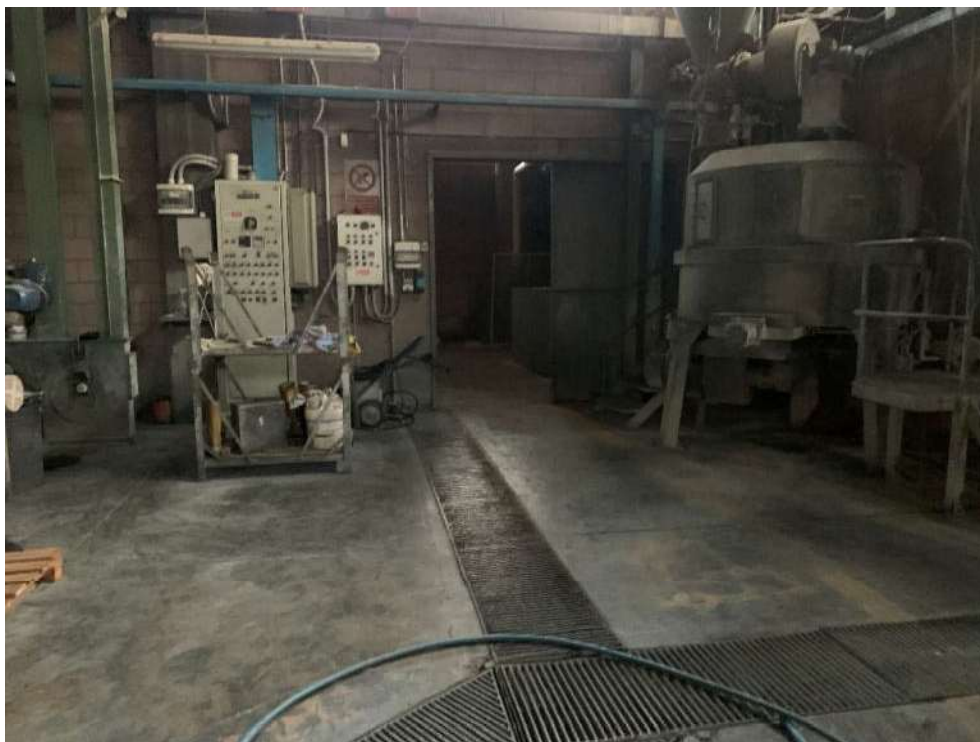
Fotografia 4: Quadro di comando del forno di pre - essicazione (M5)
