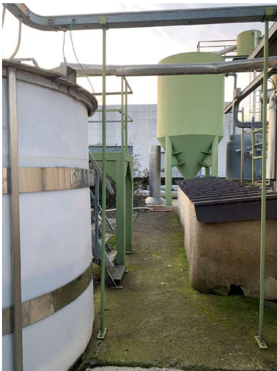
Fotografia 42: Silos calce viva
