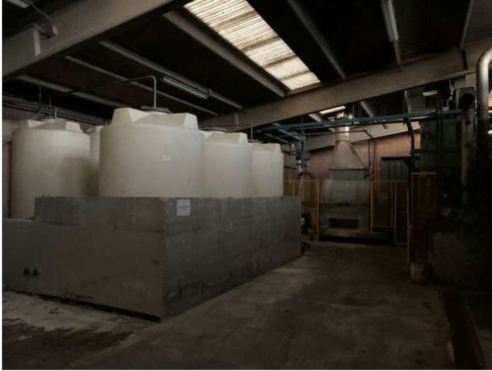
Fotografia 6: Depositi (vasche) acido solforico
