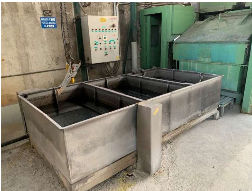
Fotografia 31: Vasche di contenimento acido solforico
