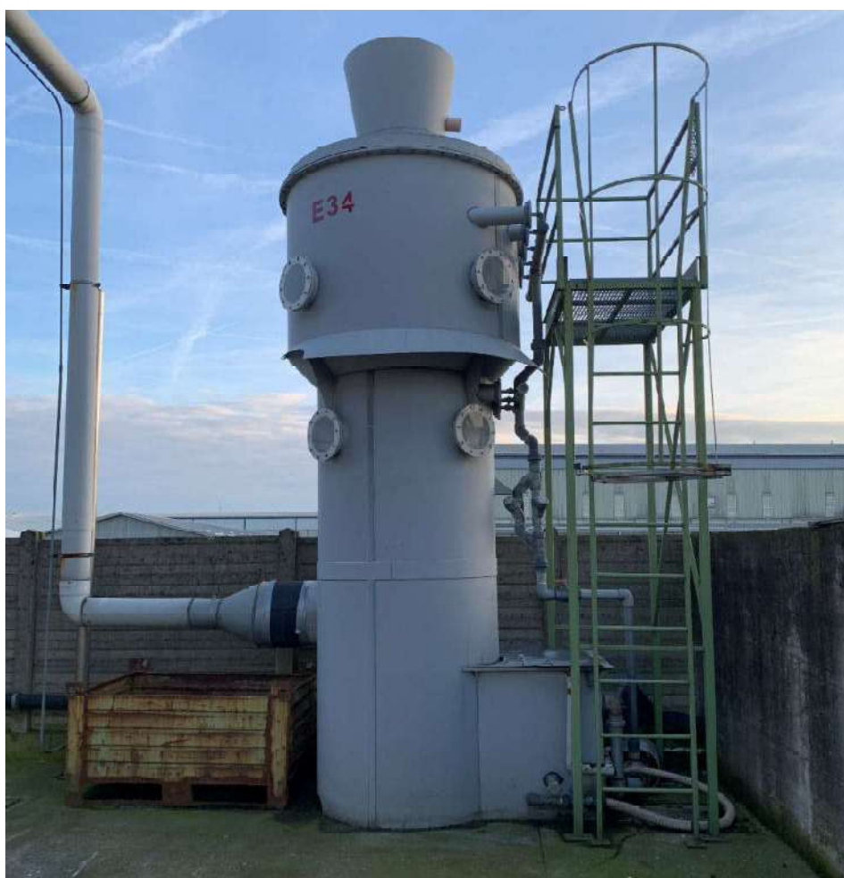
Fotografia 41: Scrubber a umido (Emissione E34)
