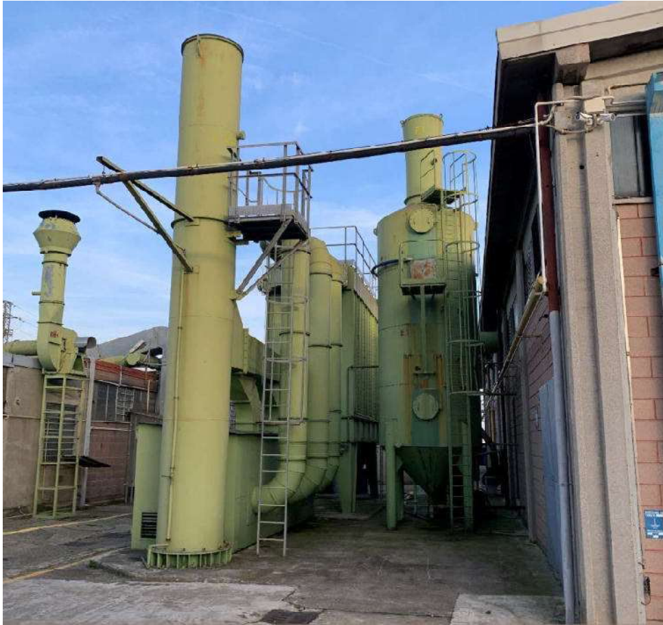
Fotografia 43: Scrubber a umido e filtri a maniche
