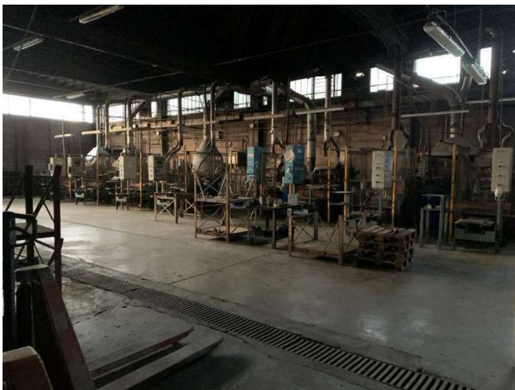
Fotografia 5: Forni fusori (M1, M2, M3 e M4)
