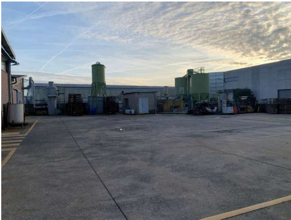
Fotografia 38: Vista impianto depurazione acque reflue
