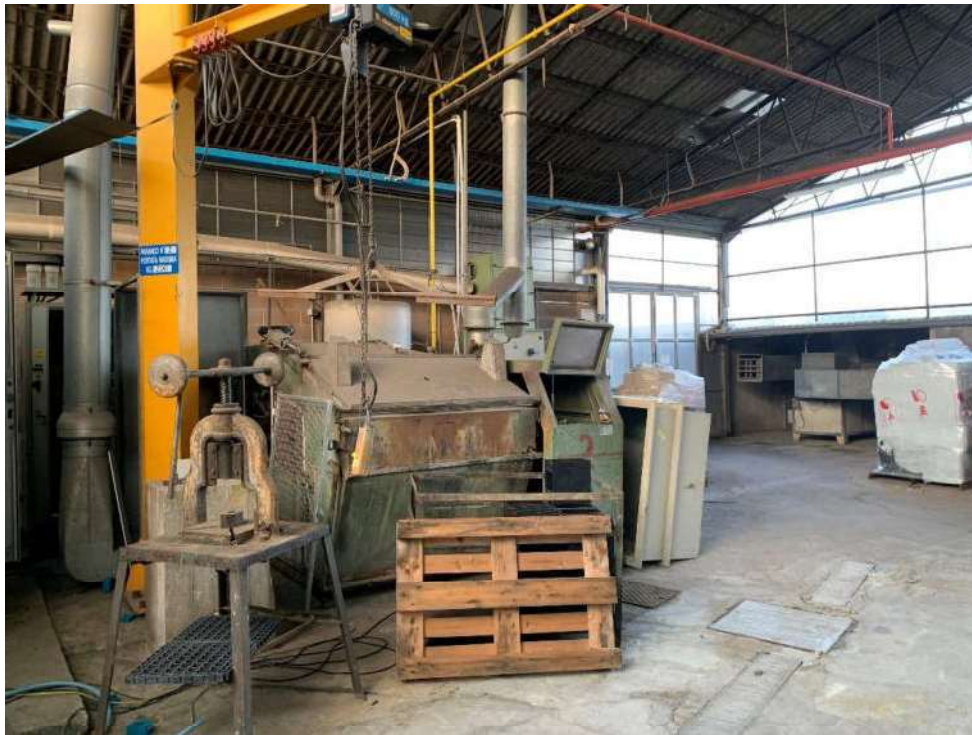
Fotografia 30: Panoramica reparto precarica con forni essicatori (M15)
