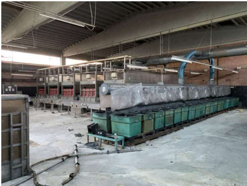
Fotografia 9: Vasche di carica di batterie/piastre
