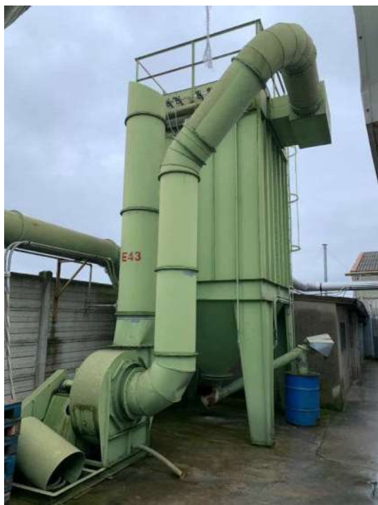
Filtro a maniche vicino al deposito 8 (Edificio 1) con polvere di piombo
