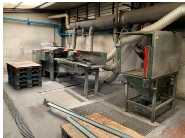
Canaline per la raccolta della pasta di piombo nel reparto 6 dell'Edificio 1
