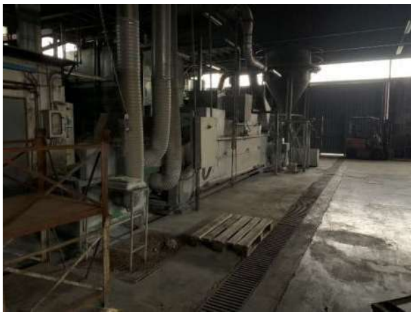
Canaline per la raccolta della pasta di piombo nel reparto 16 dell'Edificio 2
