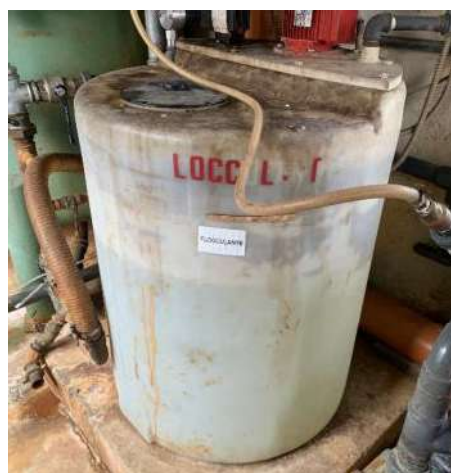
Serbatoio con flocculante
