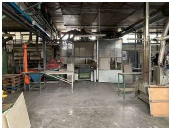
Forno C.O.S. M16 dell'Edificio 1
