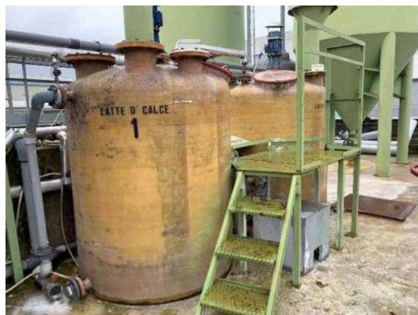
Coppia di silos con latte di calce
