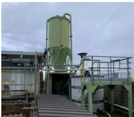
Silos di calce viva e latte di calce
