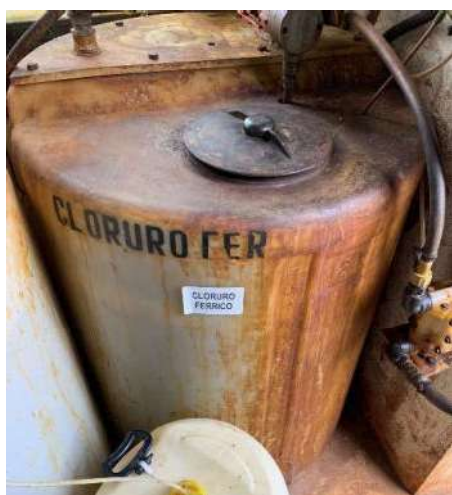
Serbatoio con cloruro ferrico
