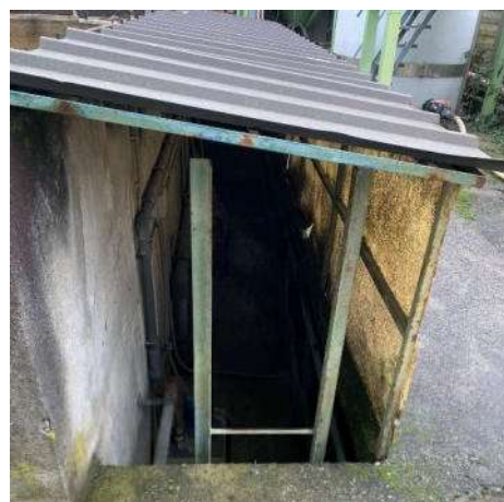
Vasche interrate da dismettere
