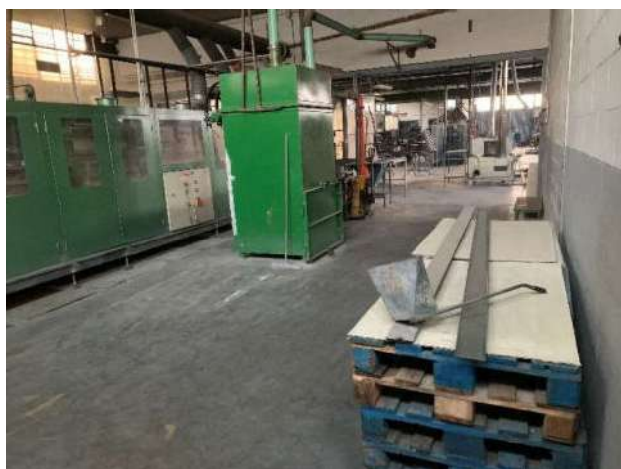
Filtro a maniche vicino a imbustatrice M10 dell'Edificio 1 con polvere di piombo
