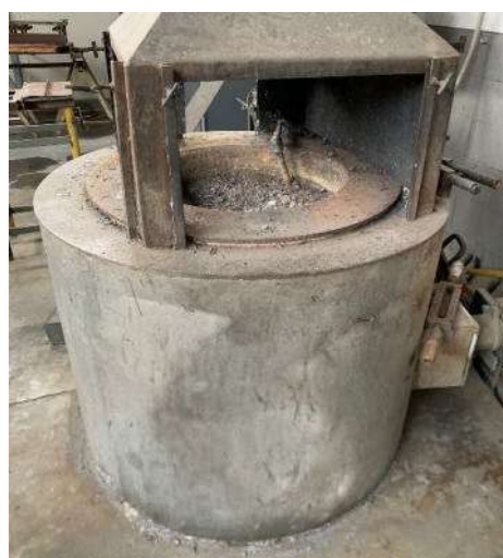
Forno accessorio M14 dell'Edificio 1
