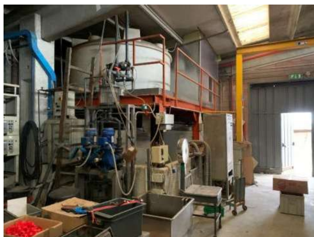
Serbatoi contenenti acido solforico del reparto 15 bis dell'Edificio 2
