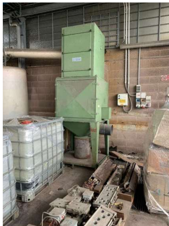
Scrubber a umido nel reparto 13 dell'Edificio 1 con polvere di piombo
