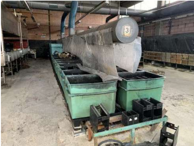
Vasche piccole contenenti acido solforico
