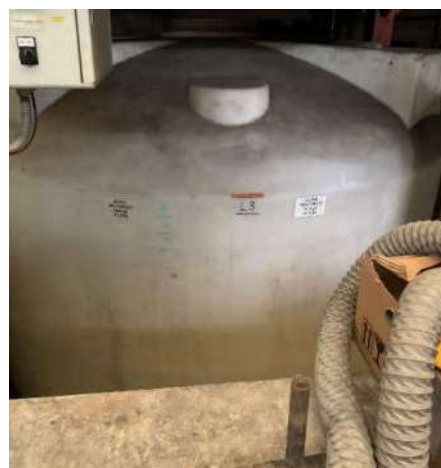
Serbatoi contenenti acido solforico del reparto 15 bis dell'Edificio 2
