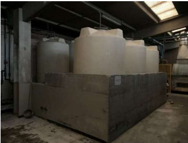
Serbatoi contenenti acido solforico del reparto 17
