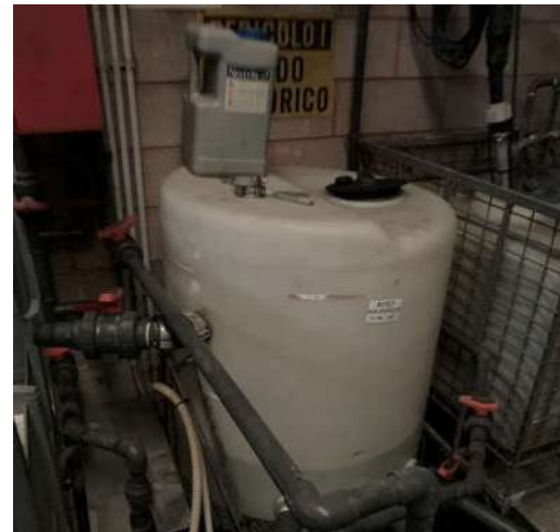
Cisterna contenenti acido solforico del reparto 17
