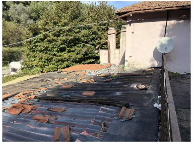
Copertura dell'altra sala ristorante a sud-ovest in pessime condizioni
