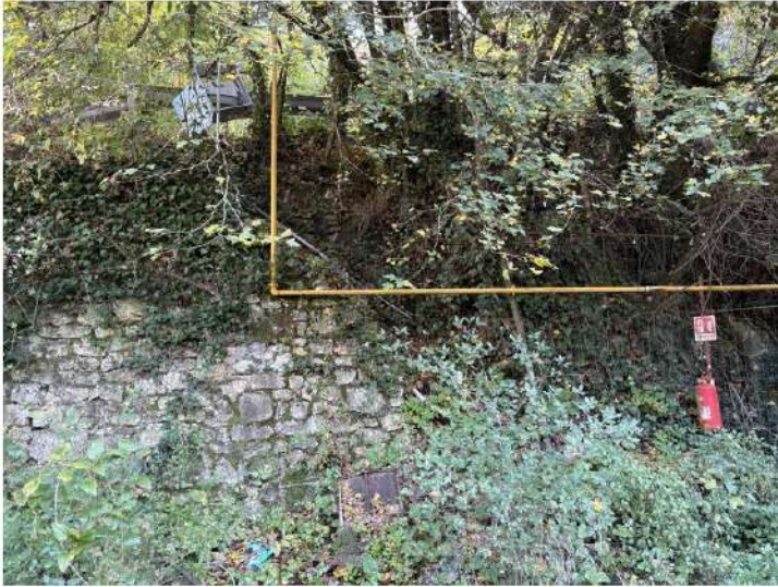
Tubazione da deposito GPL a alloggiamento Contatori su strada
