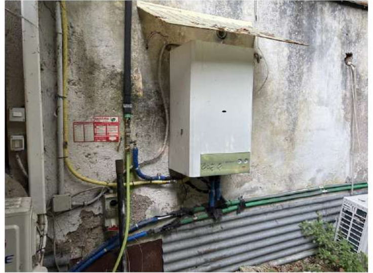
Caldaia per la produzione di acqua calda sanitaria (dismessa)
