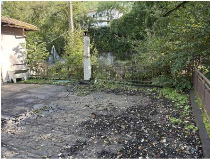
Lastrico di copertura dei locali sottostanti non pavimentato
