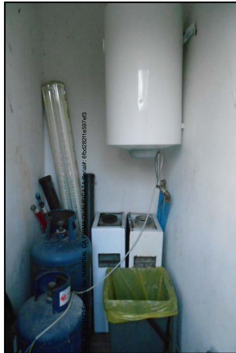
Foto n° 15 Locale caldaia Piano Terra
