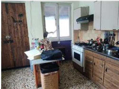
Ingresso con cucina non autorizzata
