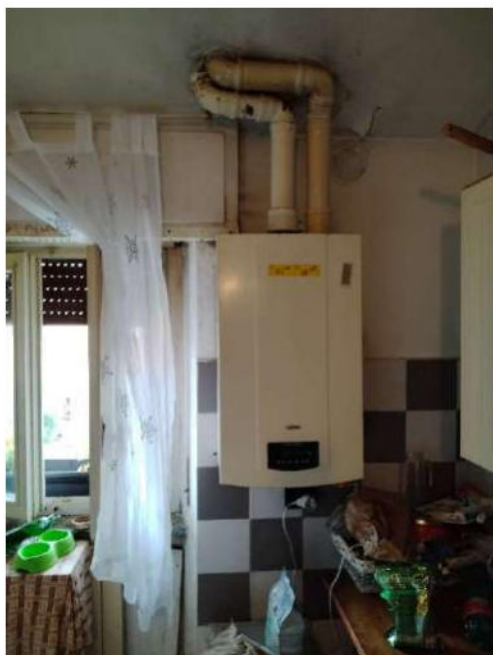
8) Vista della cucina dove è posizionata la caldaia;
