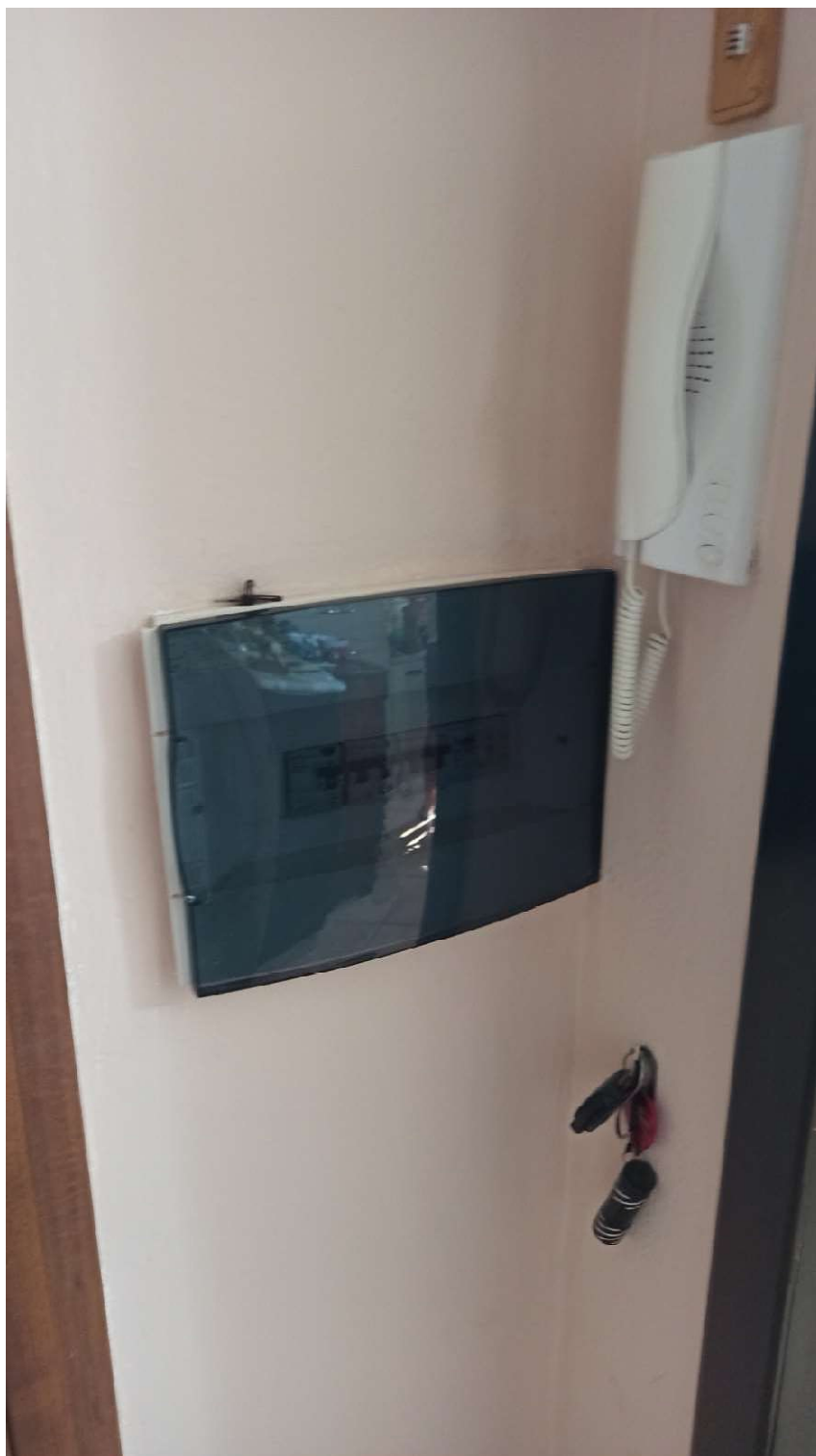
FOTO 33 – QUADRO IMP. ELETTRICO
