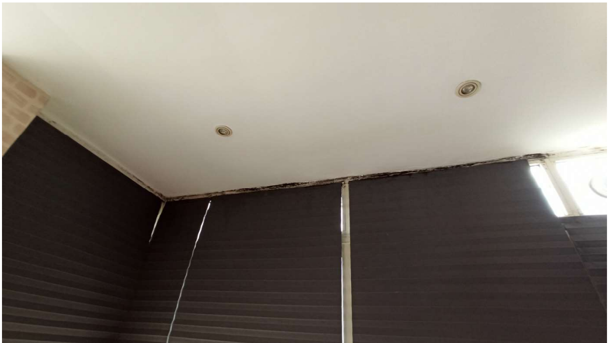
FOTO 29 – DETTAGLIO UMIDITÀ INFISSO DELLA CUCINA
