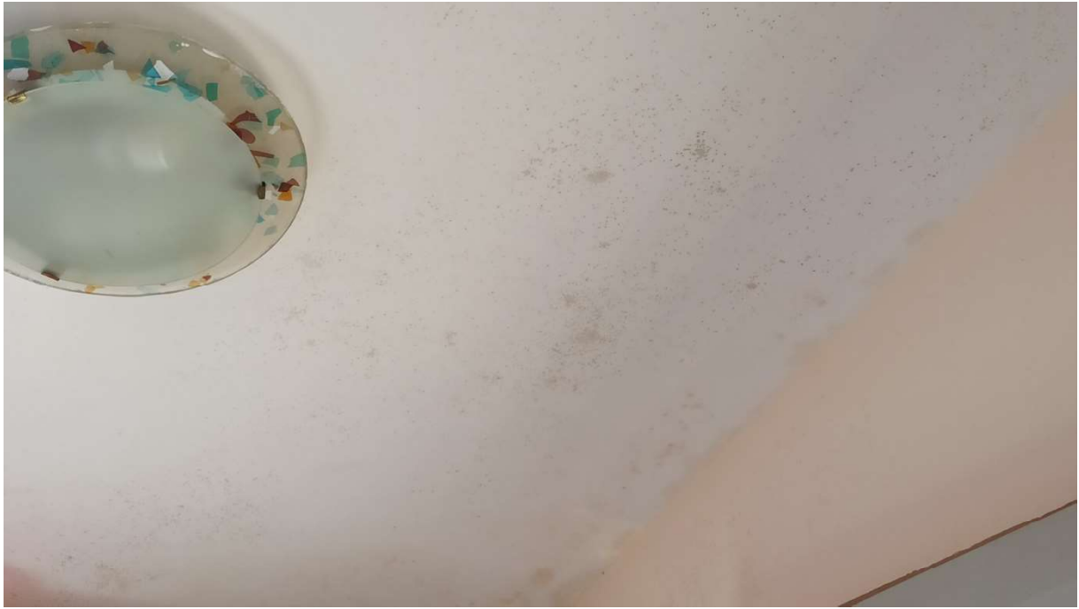
FOTO 28 – DETTAGLIO UMIDITA' RIPOSTIGLIO
