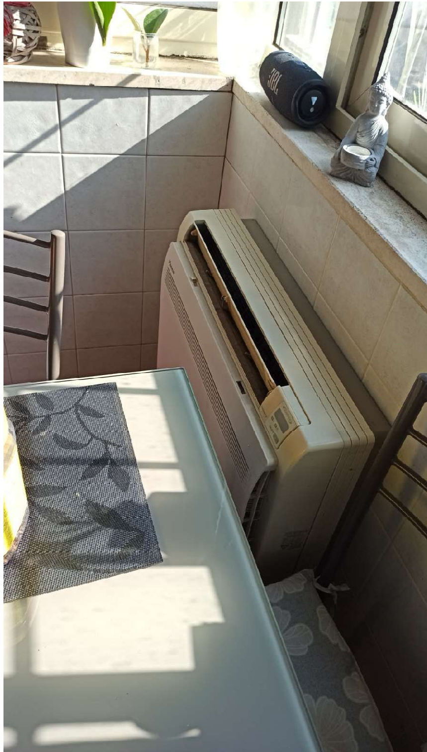
FOTO 32 – TERMOCONVETTORE IN CUCINA
