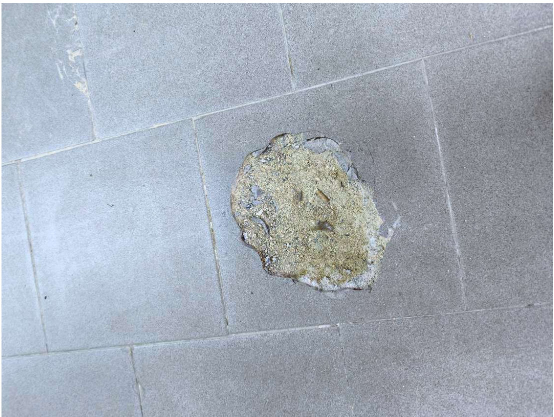
Foto n. 9: Particolare pavimentazione ammalorata – locale a sinistra del prospetto principale
