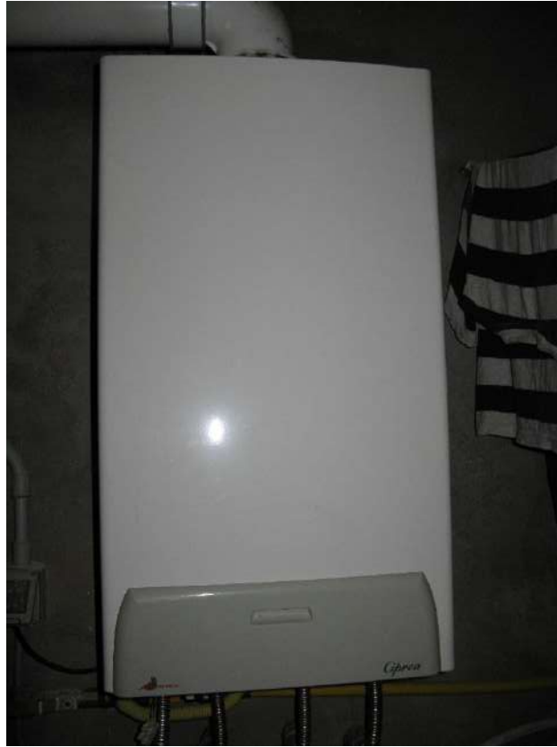
Foto 37 – Centrale termica al piano terreno – Bene 3
