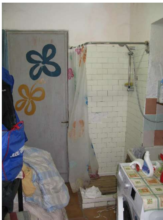
Foto 36 – Lavanderia al piano terreno – Bene 3
