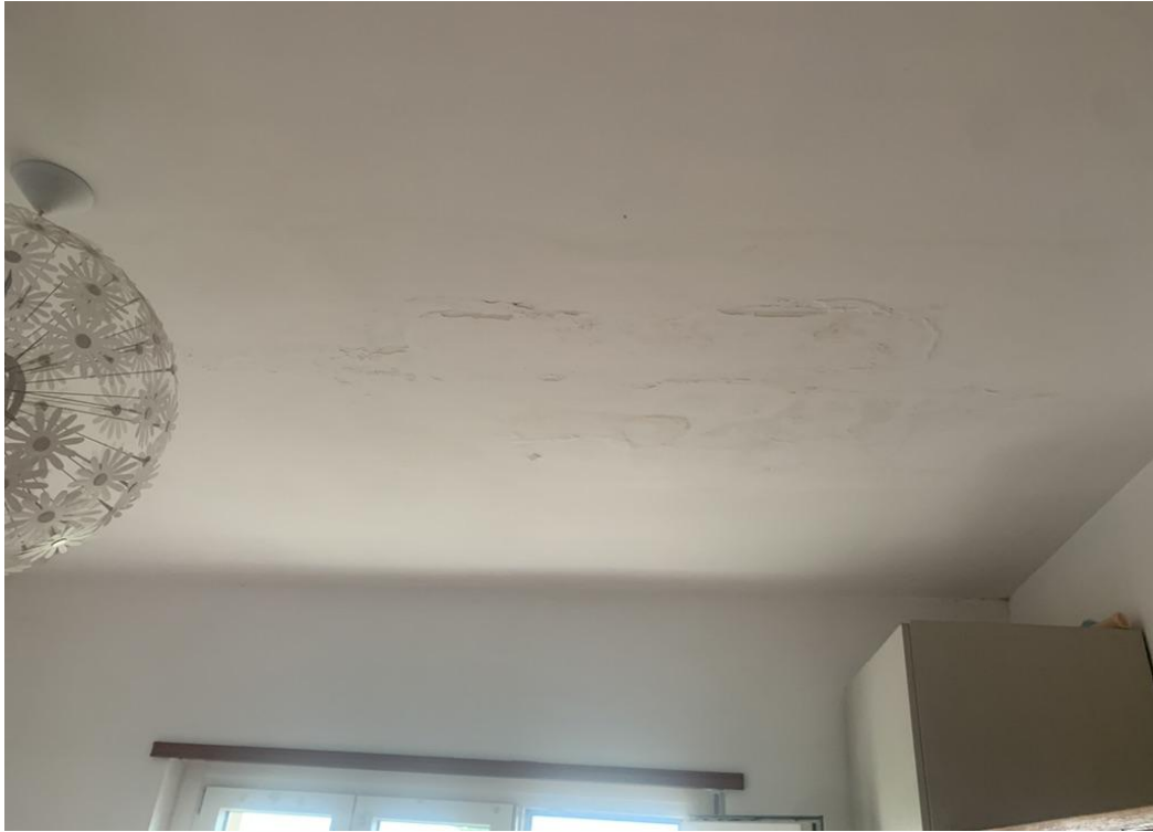
Foto n° 13 – infiltrazioni dalla copertura
