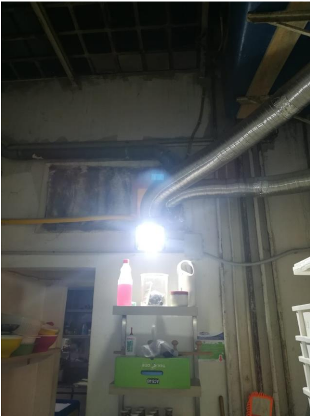
Foto n. 11 : Chiostrina –dettaglio impianto di areazione;
