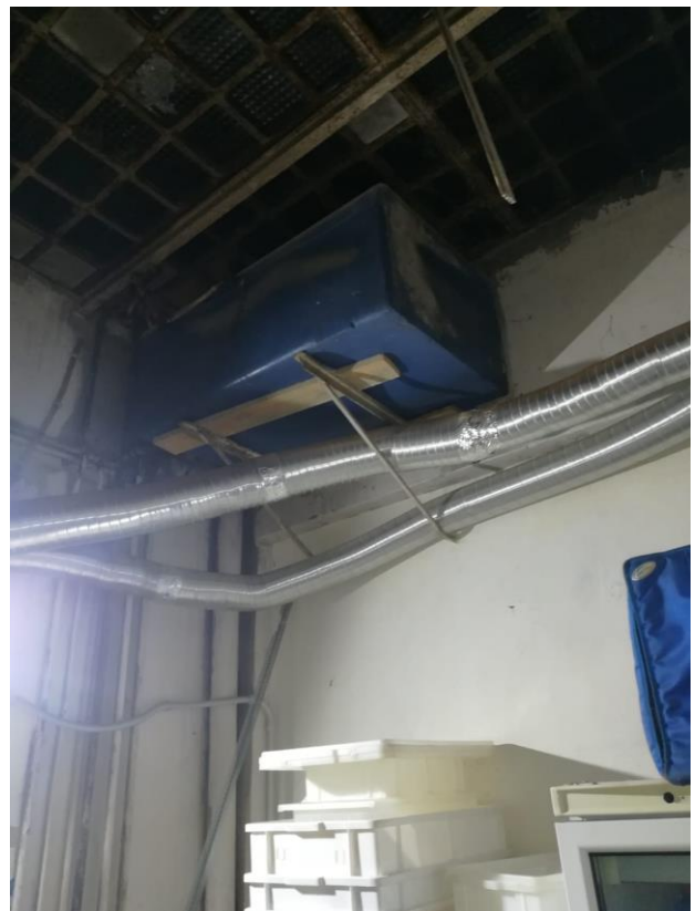
Foto n. 10 : Serbatoio acqua presente nella chiostrina;
