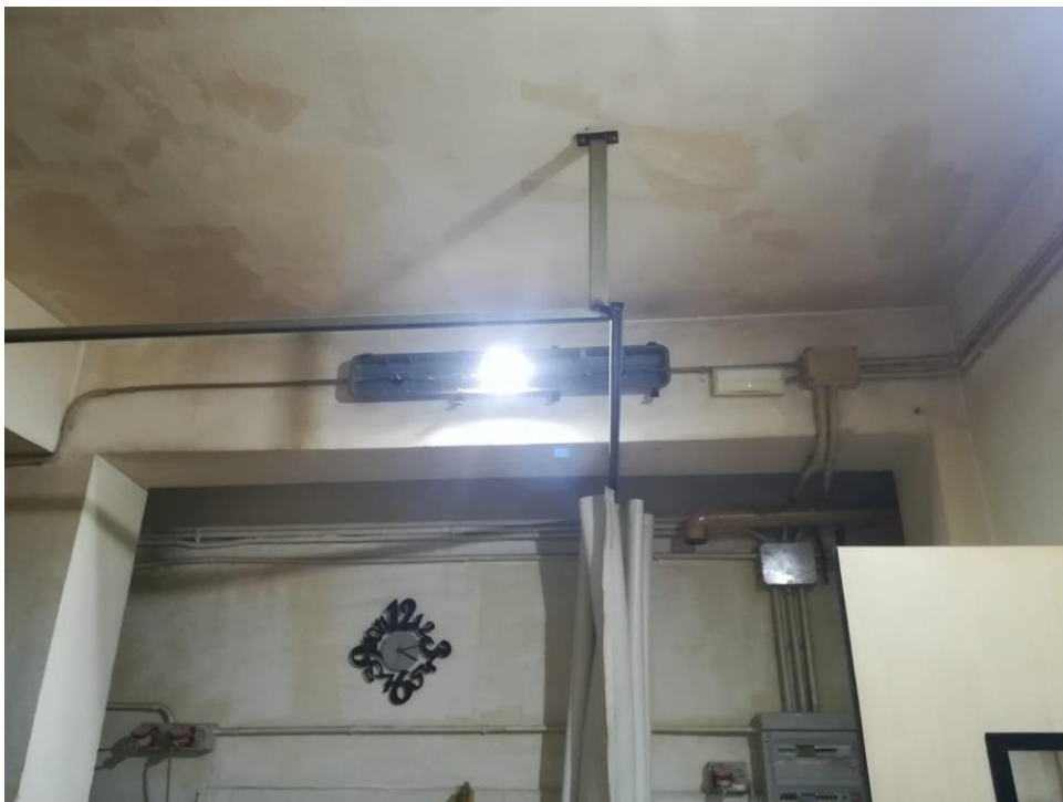
Foto n. 8 : Soffitto della zona per la preparazione del pane ;
