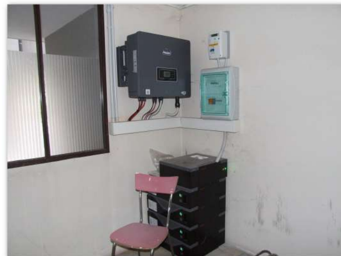
24. Apparati dell'impianto fotovoltaico comune
