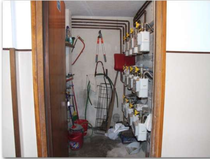
26. Locale contatori gas metano e acqua
