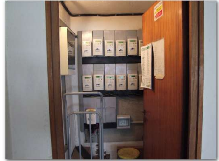
27. Locale contatori elettrici
