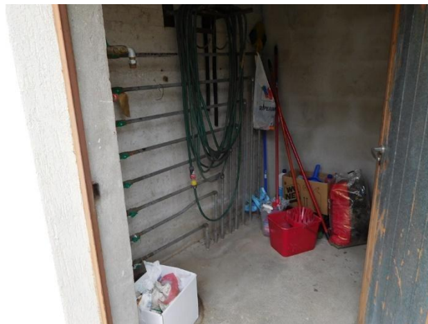
Foto 38 – piano terra – locale comune contatori acqua
