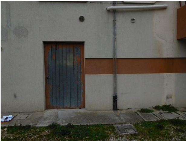
Foto 37 – vista da est – locale comune contatori
