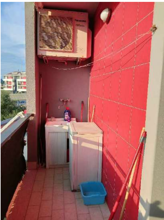
FOTO 15 – Balcone 2 – Macchina esterna impianto di climatizzazione
