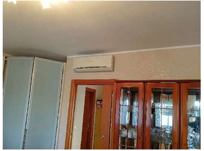
FOTO 20 – Diffusore split ubicato nel soggiorno
