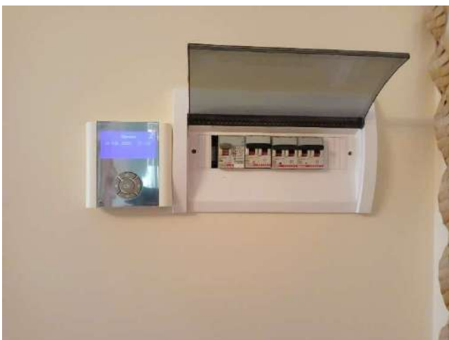
FOTO 17 – Quadro elettrico e cronotermostato
