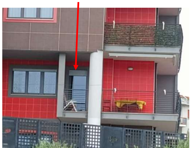
FOTO 22 – Particolare difformità in facciata (porta-finestra)
