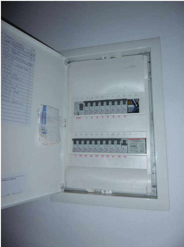
Interno – Alloggio – Quadro elettrico
