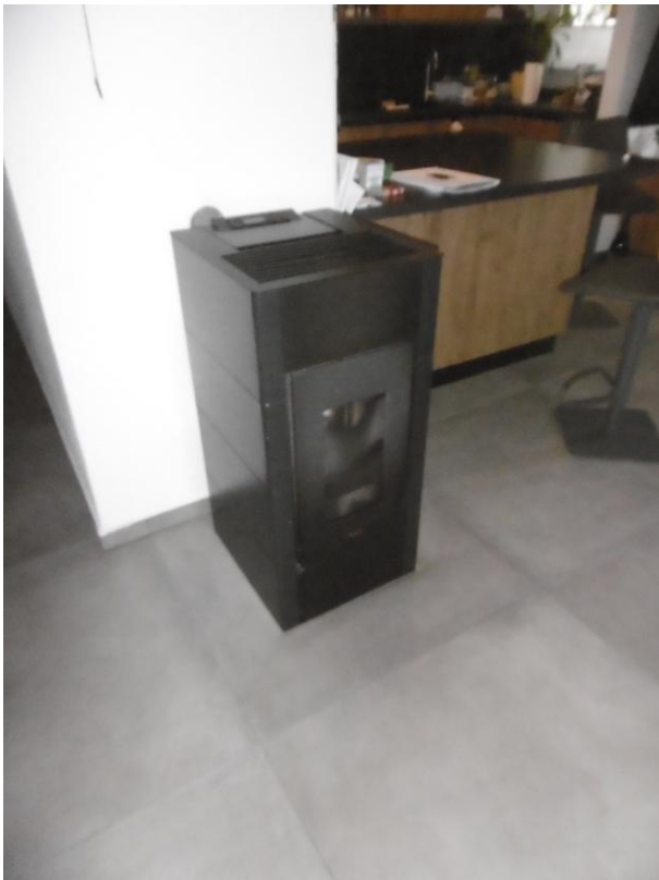
Interno – Alloggio – Stufa pellet
