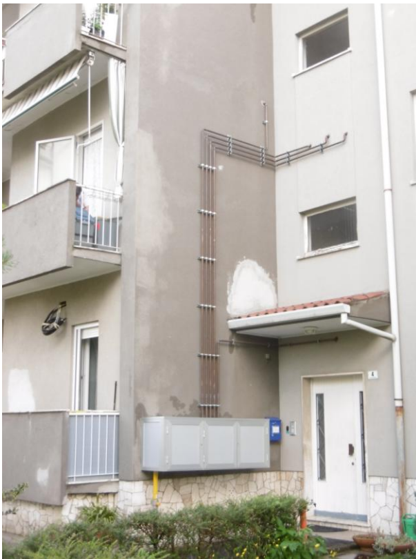
Edificio condominiale – Adduzione gas
