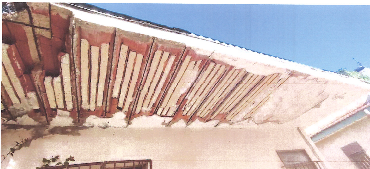
Foto 14 Sfondellamento balcone a piano terra Vittoria Foglio 190 particella 870 sub 1
