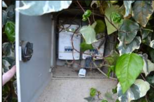
Figura 32 - Contatori linea elettrica BENE A e BENE B
