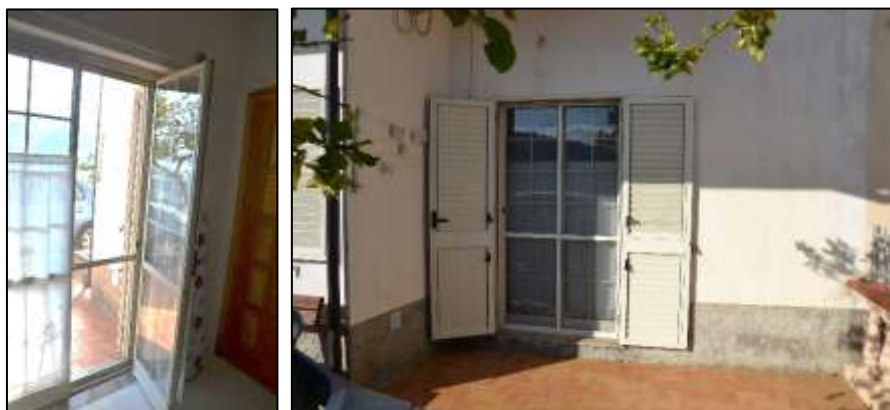
Figura 17 - Infissi esterni BENE A
