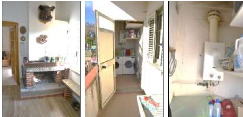
Figura 34 – A sinistra camino ubicato nel vano CUCINA. A destra generatore elettrico di ACS ubicato nel vano RIPOSTIGLIO del BENE B
