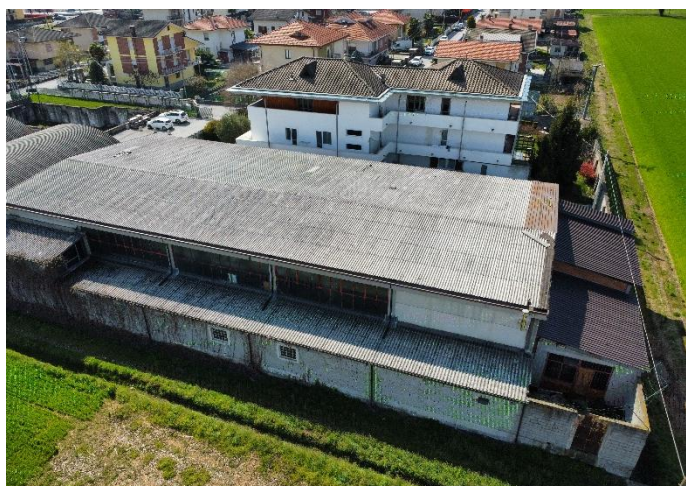
Figura : Vista della porzione di capannone, bene 4 e foto copertura con la presenza di pannelli in amianto.
