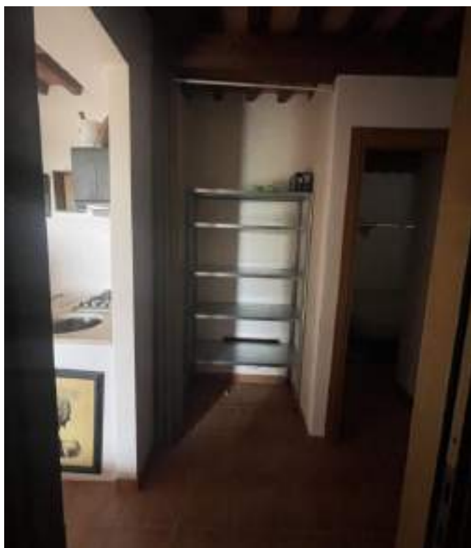
Vista 2 del disimpegno, con particolare di dove si sarebbe dovuto trovare l'ingresso principale urbanisticamente, dove vi è la scaffalatura.
