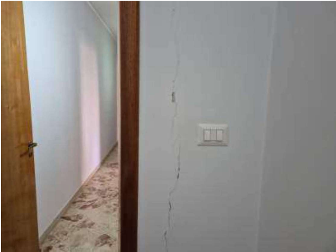
Foto 16 vista particolari deteriorati (ingresso)
