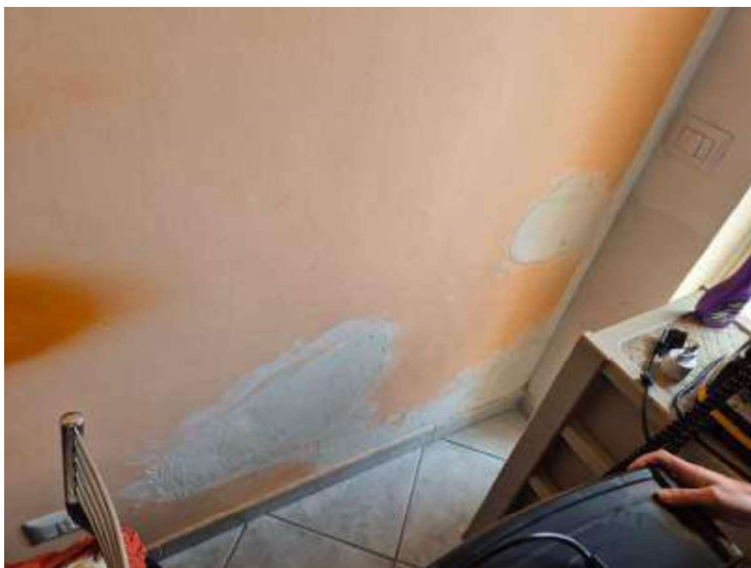
Foto 19 vista particolari deteriorati (Cucina)
