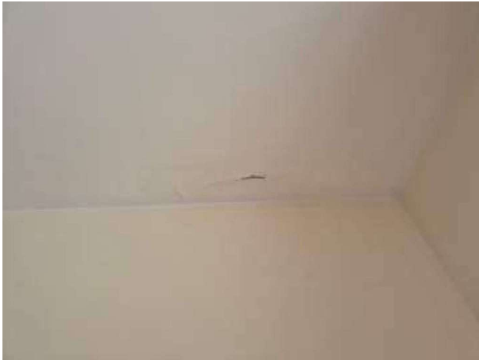
Foto 17 vista particolari deteriorati (stanza da letto)
