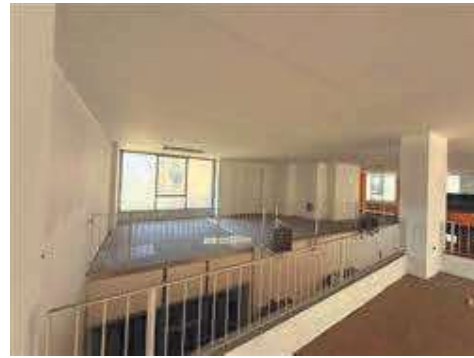
Sul fondo la porzione di soppalco abusiva
