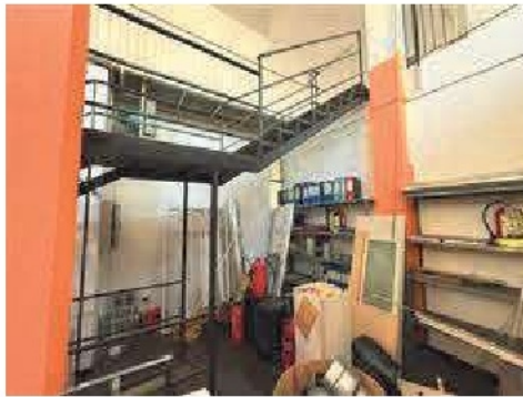
Scala di accesso al soppalco difforme da quello assentito
