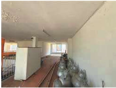
Porzione di soppalco abusiva
