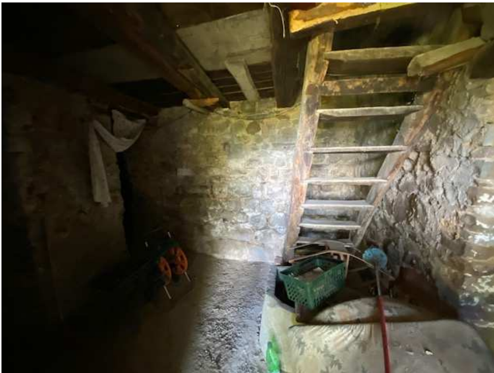
Vano (mappale 5646) gravato da servitù di passaggio per accesso cantine pignorate
