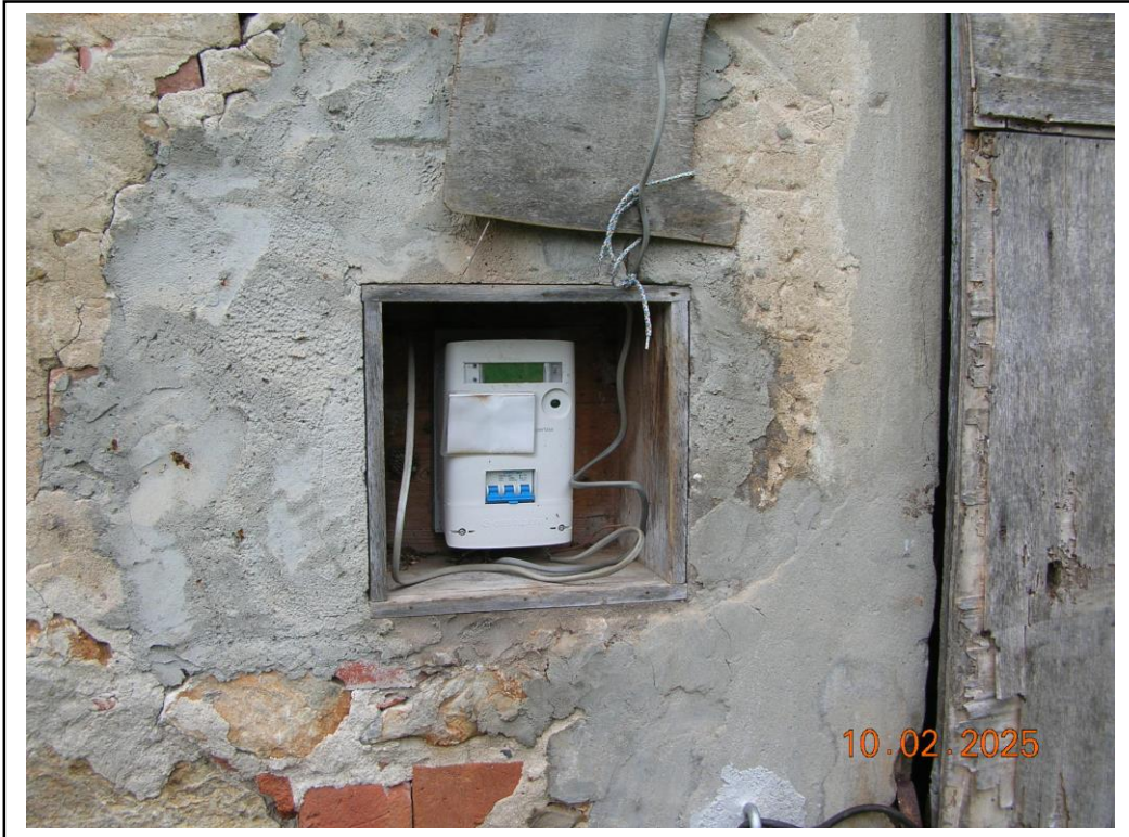
Foto 13 Impianto elettrico – Contatore Enel
