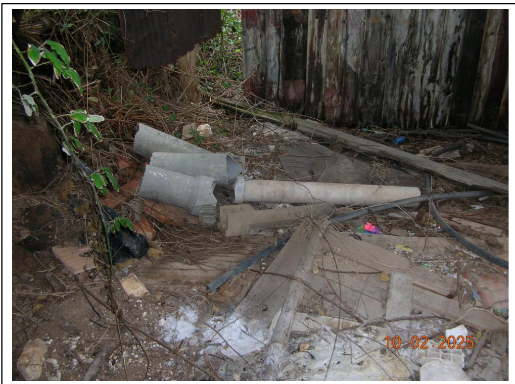
Foto 18 Porzione di canna fumaria in cemento amianto
