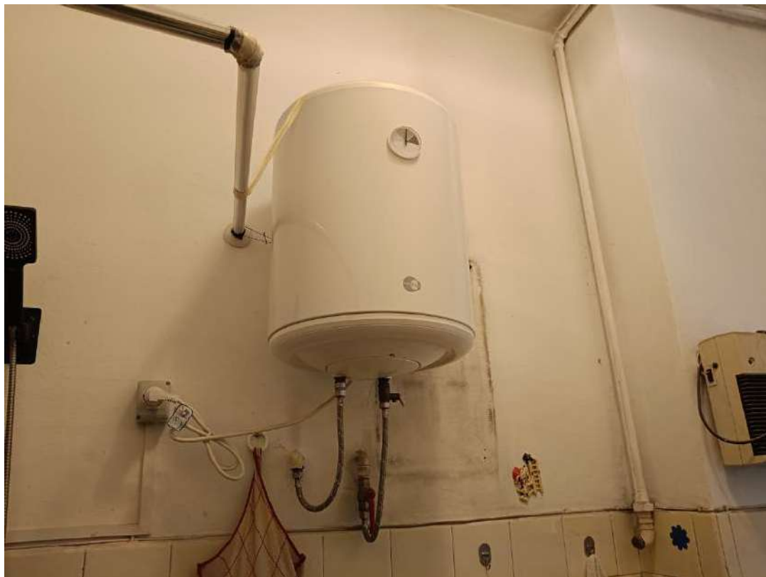
Dettaglio – Boiler elettrico per produzione acqua calda sanitaria
