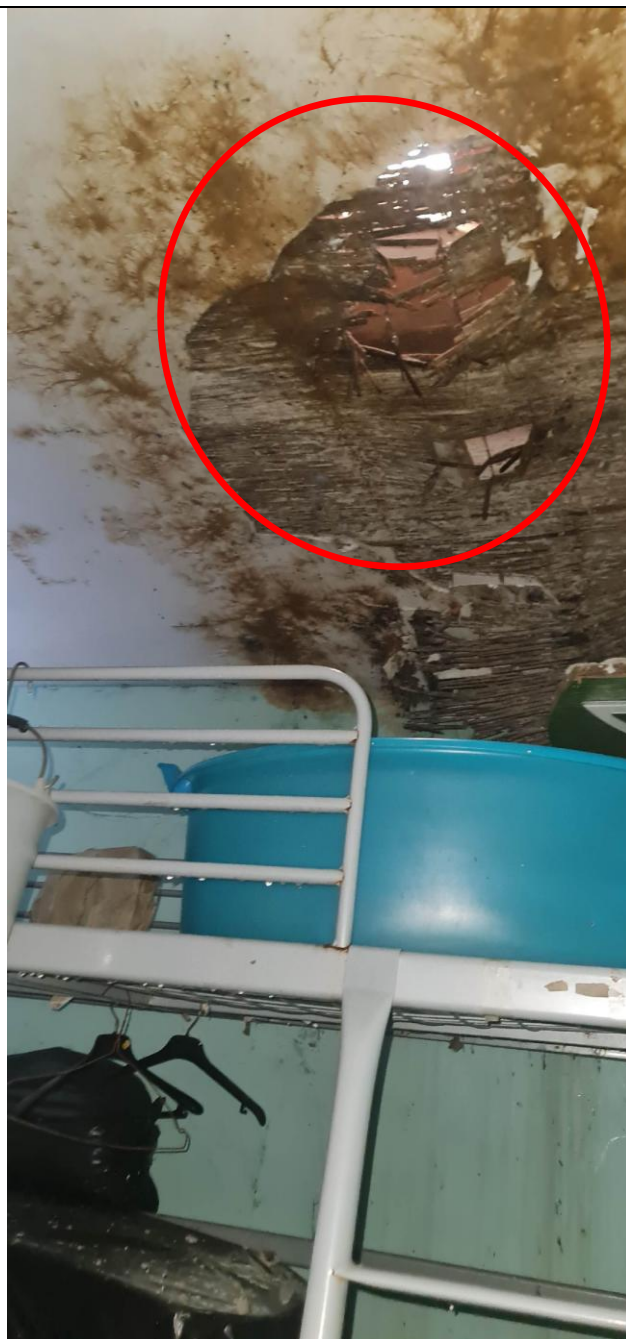
Immobile 3 piano primo – soffitto camera stanza Nord-Ovestcon - notevole infiltrazione e ampie porzioni di tetto mancante e crollato
