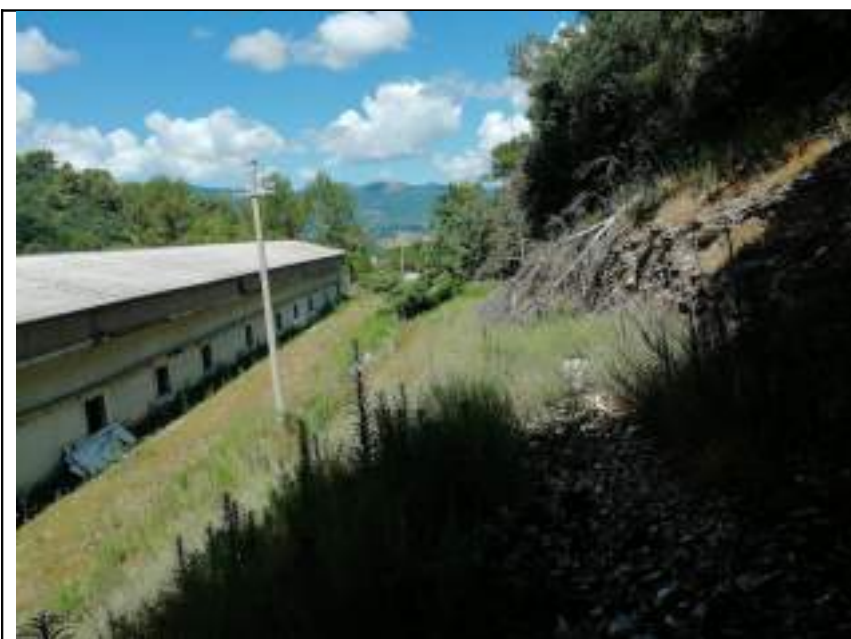
20 – Strada da ripristinare
