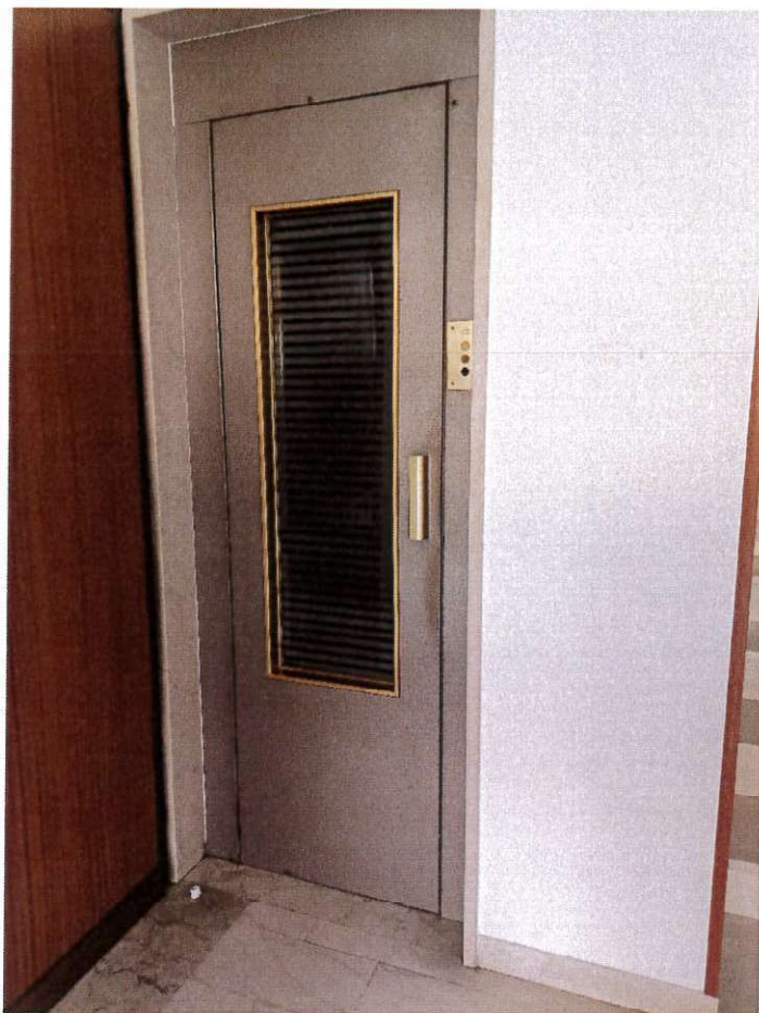
Foto n. 15 Viste Ascensore e scale
